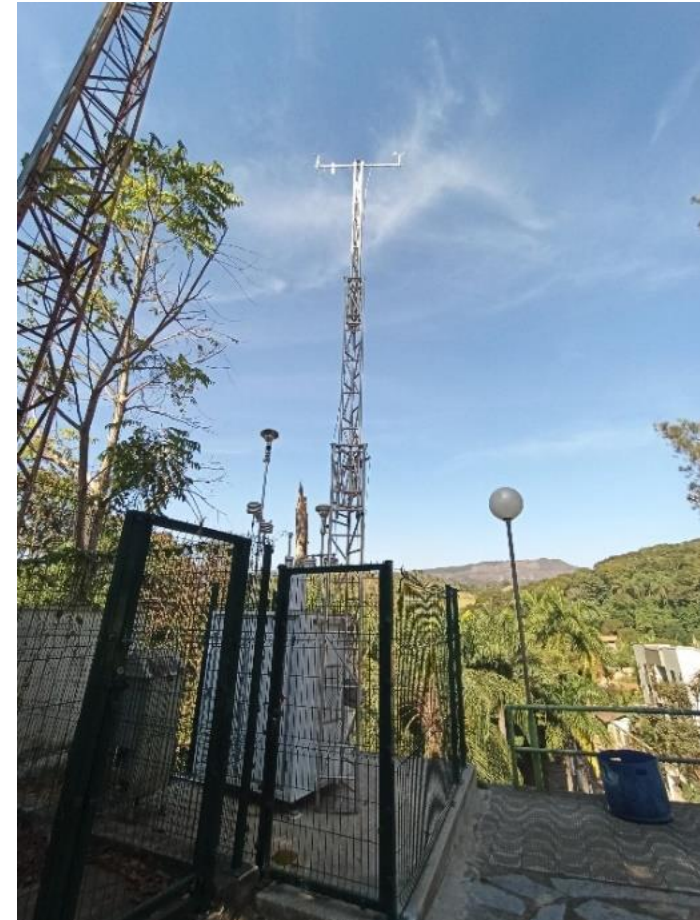
Figura 21 Estação de Monitoramento Automática em São Gonçalo do Rio Abaixo
