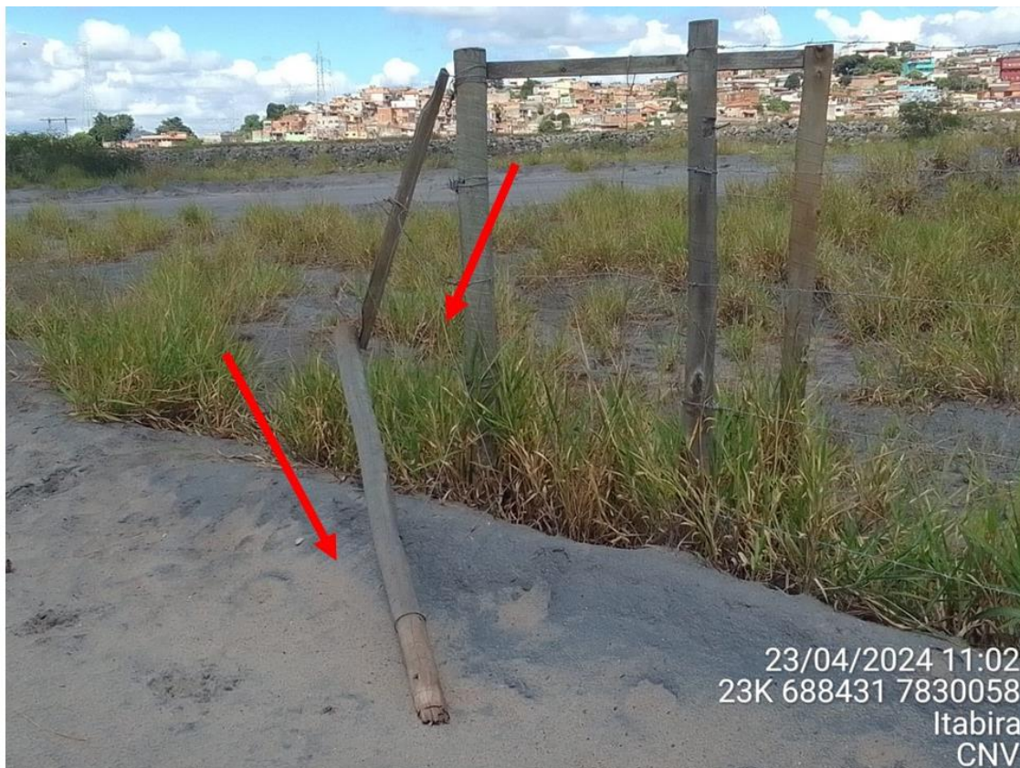
Figura 33 e Figura 34. Evidências de cercas rompidas. Fonte: Vale, 2024.
