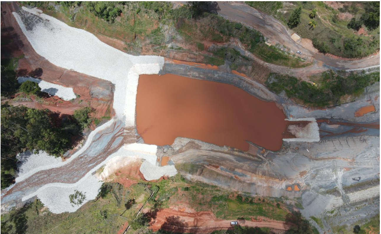
Foto 1. Sump - etapa I do projeto de rebaixamento do N.A do dique Minervino.
