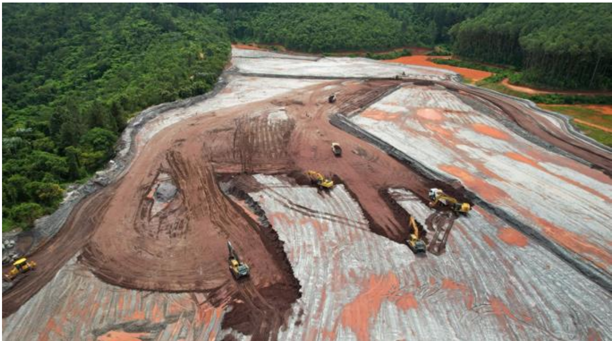
Foto 5. Carga de material da área de estoque para uso no regrade a montante do Dique 1A (abril/24).
