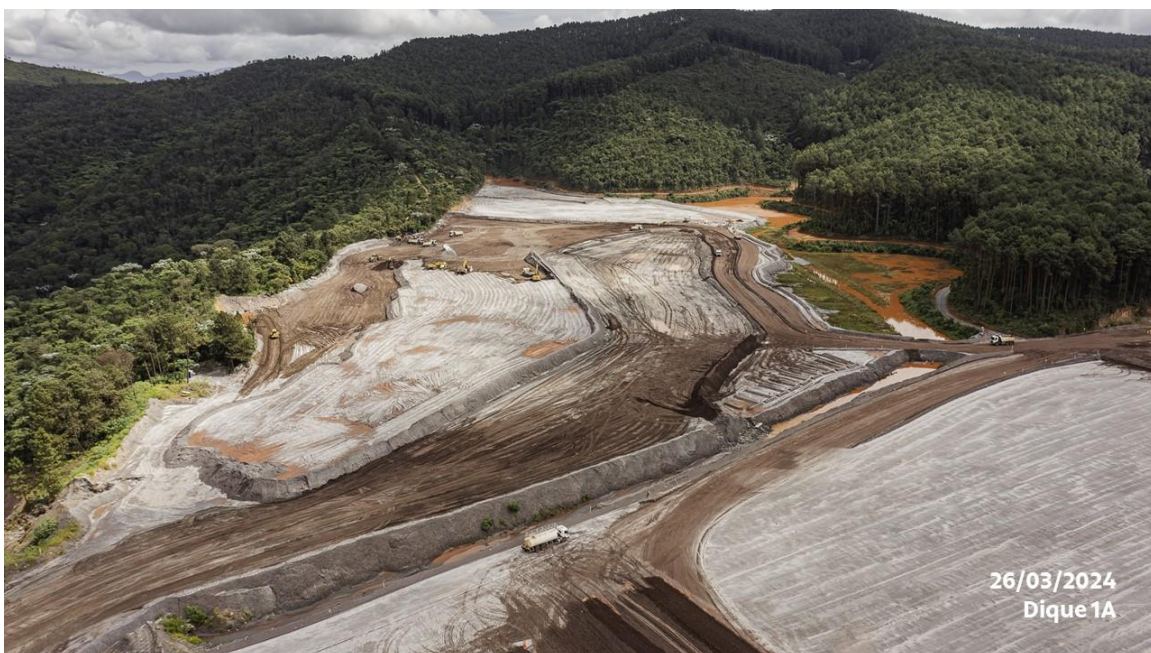
Foto 13. Canal provisório de direcionamento de água do Dique 1A para Barragem Itabiruçu. Fonte: Vale, 2024.
