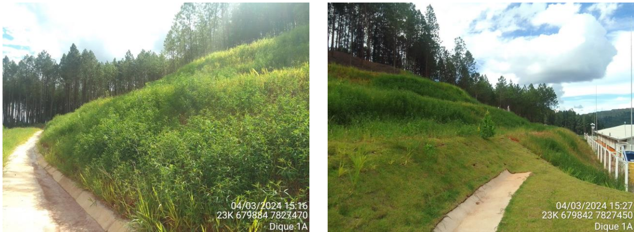
Foto 26 e Foto 27. Evolução da vegetação nos taludes na área do canteiro de obras do Dique 1A.
