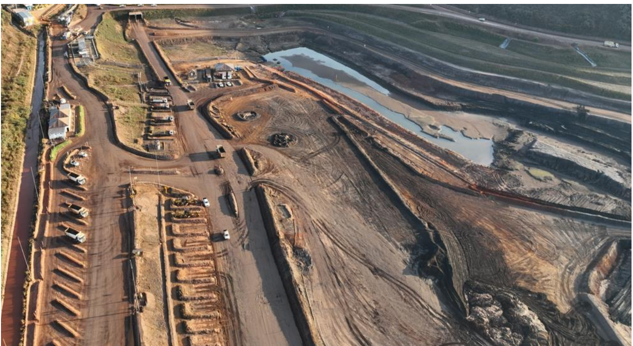
Foto 2. Vista do Sump de drenagem do reservatório com o sistema de bombeamento operantes (03/07/2024).
