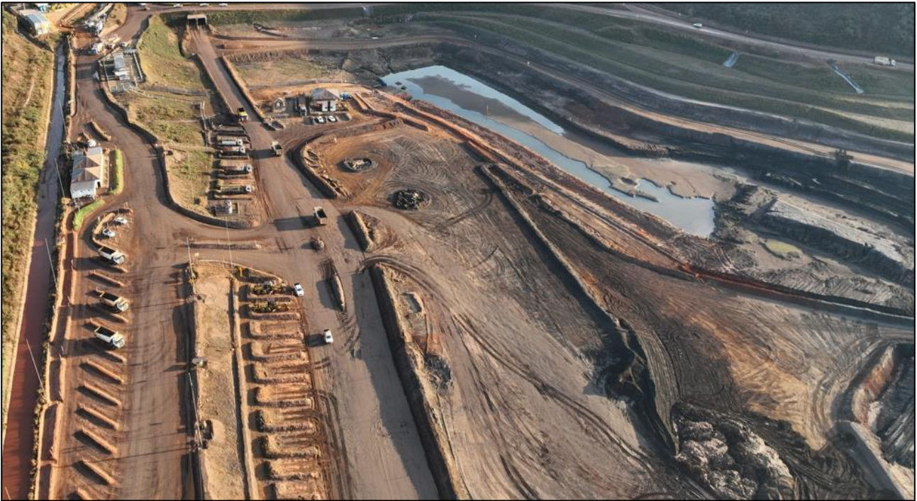
Foto 1. Vista do Sump de drenagem do reservatório com o sistema de bombeamento operantes (03/07/2024).
