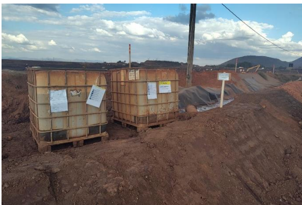
Foto 25. Dosagem de floculantes no desvio do canal CC02. (Fonte: Vale, julho de 2024)
