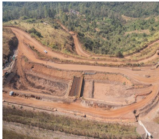
Foto 11. SUMP PDR. Fonte: Vale, 07/2024.
