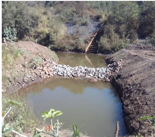
Foto 9. SUMP ECJ 2. Fonte: Vale, 07/2024.
