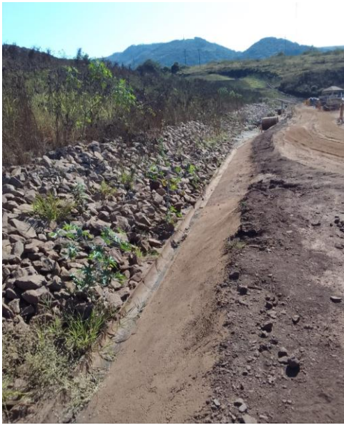
Foto 6. Drenagem PDR (julho, 2024).Fonte: Vale, 2024.
