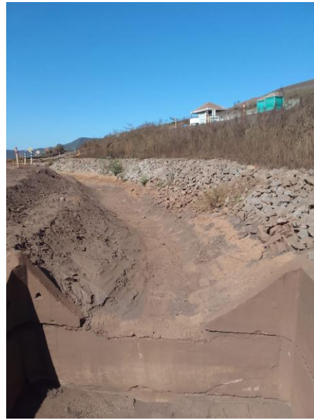
Foto 7. Drenagem PDR (julho, 2024).Fonte: Vale, 2024.
