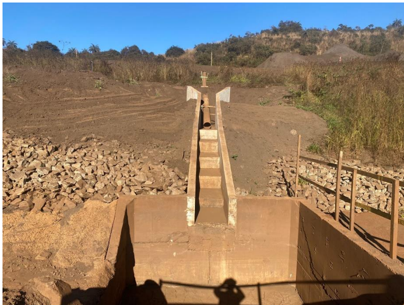
Foto 8. Drenagem PDR (julho, 2024). Fonte: Vale, 2024.
