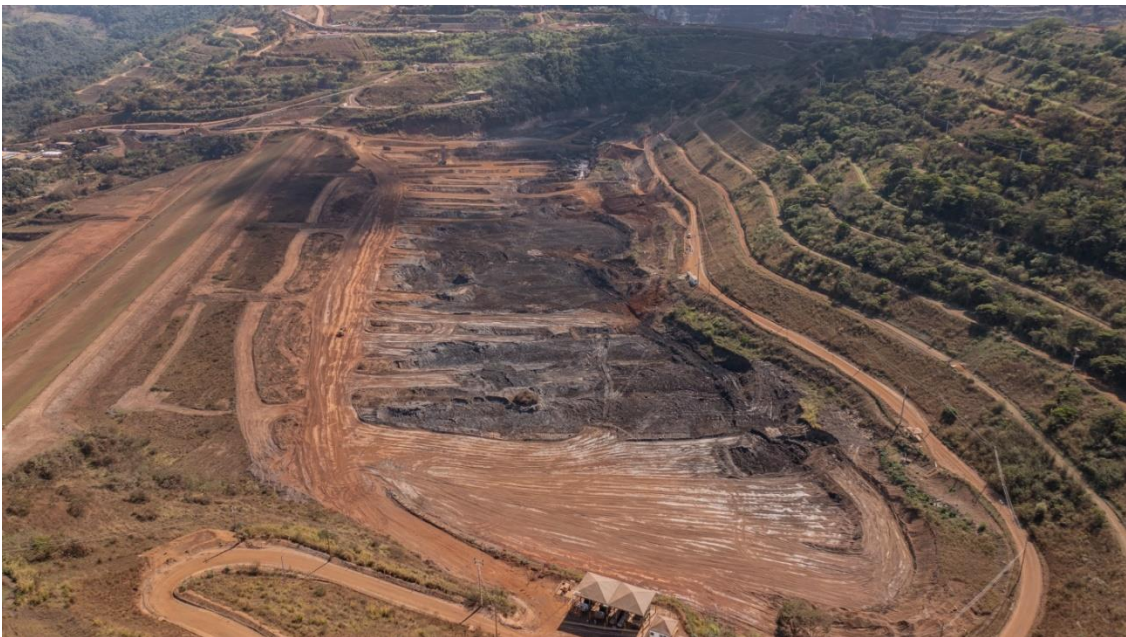
Foto 4. Vista ombreira esquerda da barragem Sul Superior – Remoção de rejeitos no reservatório (10/07/2024).
