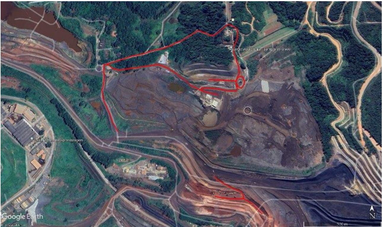
Figura 18. Rotograma atualizado de aspersão para as obras na Barragem Grupo – Construtora Aterpa. Fonte: Vale, julho de 2024.
