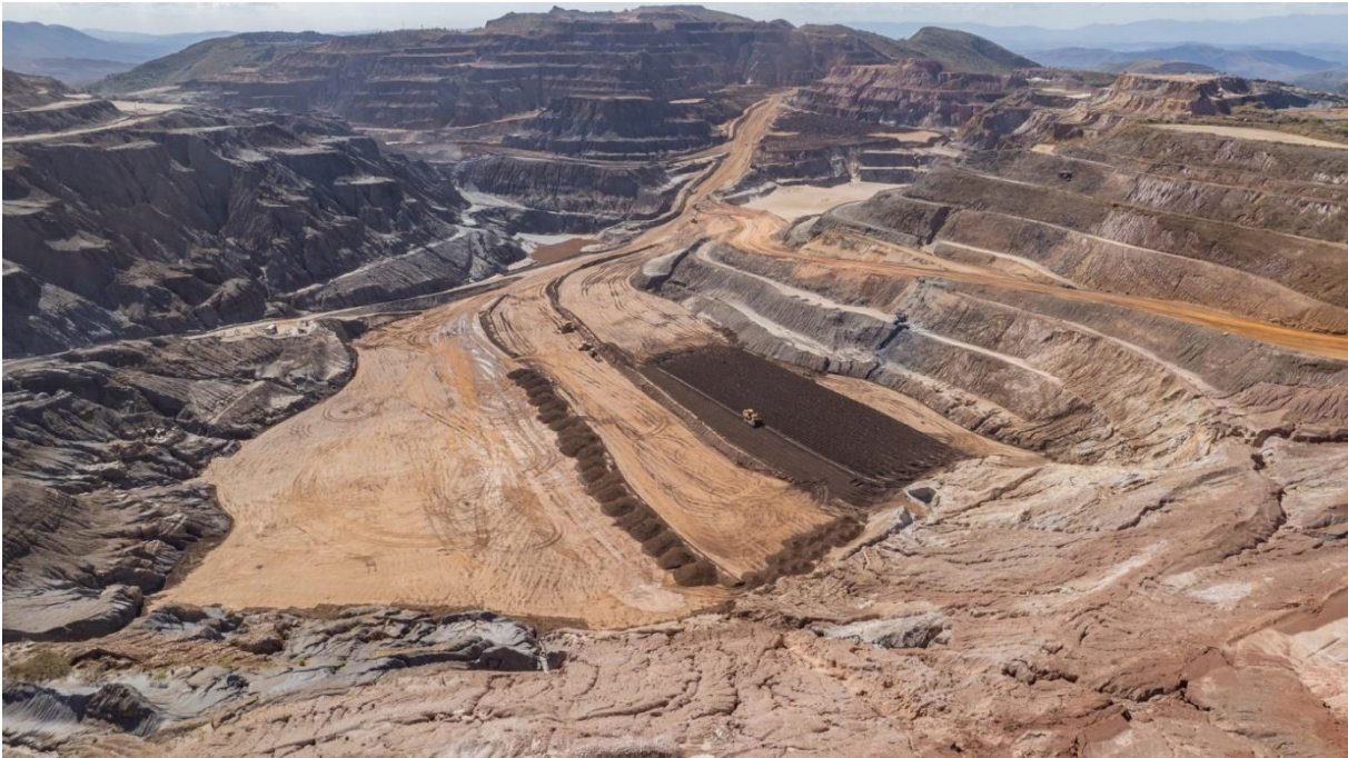
Foto 7. Disposição final em aterro compactado do rejeito de Grupo na Cava 5 (Julho/24).
