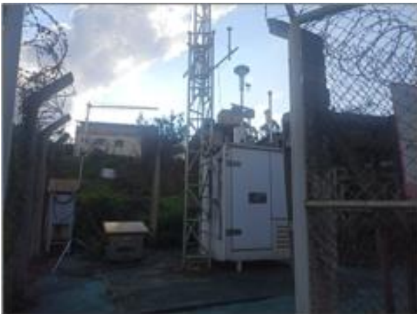
Foto 40. Estação de Monitoramento de Qualidade do Ar de Pires.
