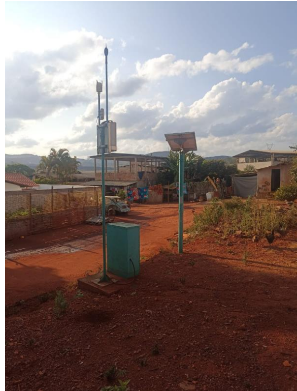
Foto 32. Estação de Monitoramento de Ruído na localidade de Mota. Vale, 2023.
