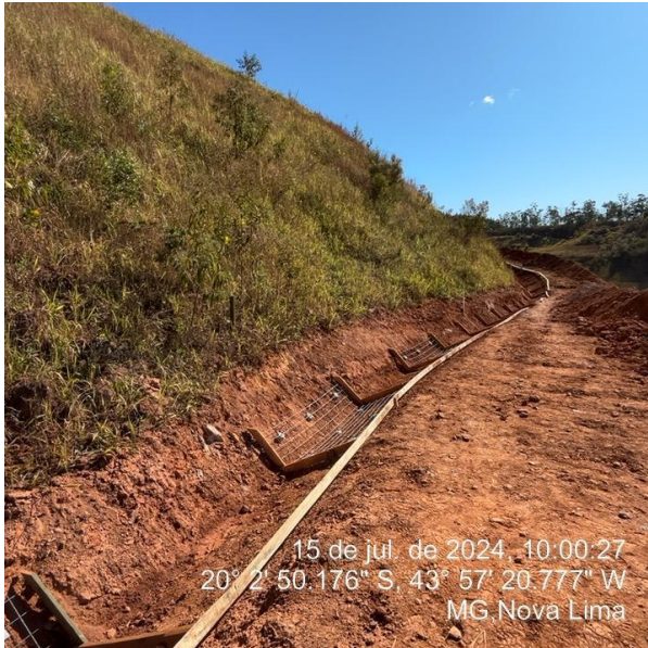
Foto 5. Execução de canaletas na ombreira direita - Obras de execução do PRAD. (Fonte: Vale, julho de 2024).
