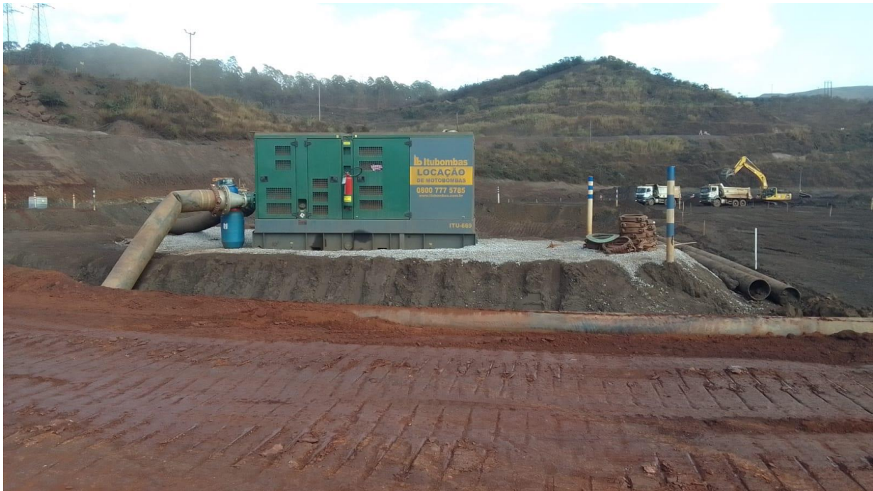
Foto 2. Sistema de bombeamento implantado nos sumps - Recomendação A9-0204 (Julho/24)
