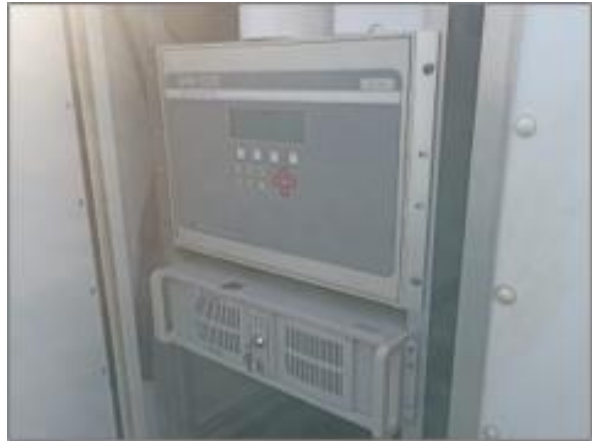
Foto 47. Estação de Monitoramento de Qualidade do Ar de Mota. Fonte: Vale, agosto 2023.
