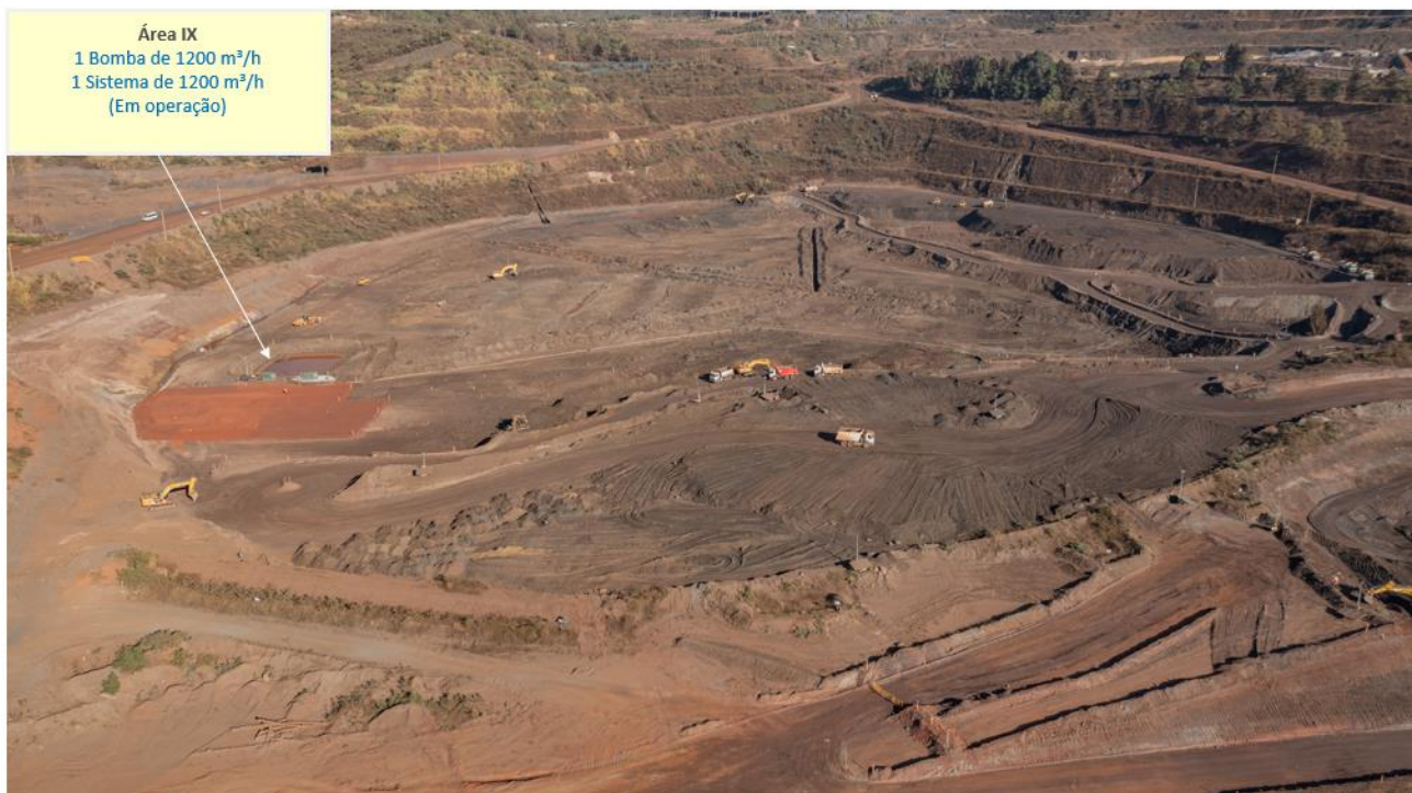
Figura 15. Sistema de bombeamento operante reservatório Área IX (Julho/24)
