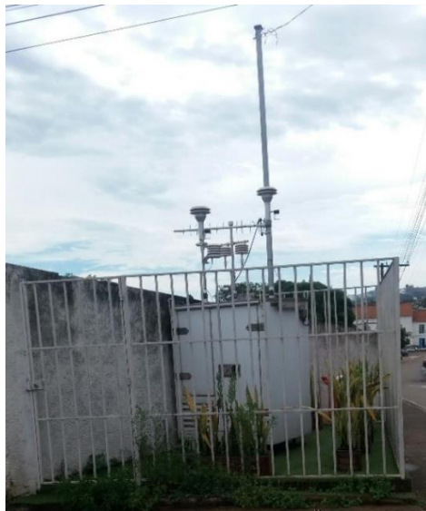
Foto 48: Estação de monitoramento de Qualidade do Ar - Matriz. Fonte: Vale, 2024.
