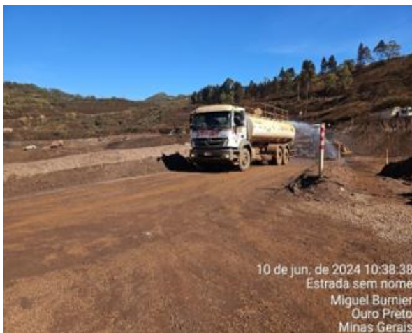
Foto 41: Aspersão frentes de obras da contrata Aterpa (canteiro DB). Fonte: Vale, junho, 2024.
