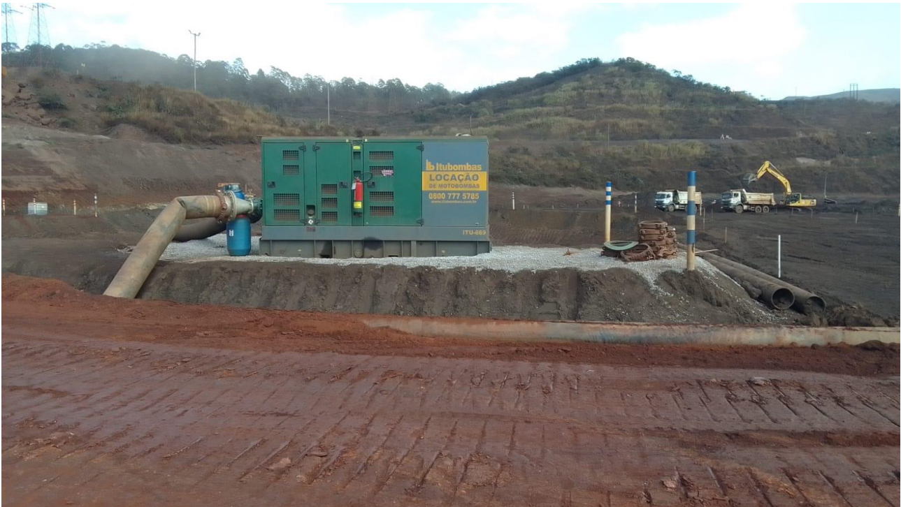
Foto 18. Sistema de bombeamento operante reservatório Área IX (Julho/24).
