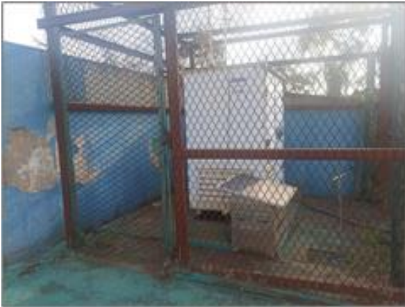
Foto 46. Estação de Monitoramento de Qualidade do Ar de Mota. Fonte: Vale, agosto 2023.
