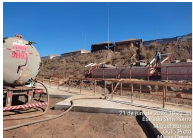
Foto 52: Sucção de efluente sanitário armazenado nos tanques sépticos. Vale, junho de 2024.
