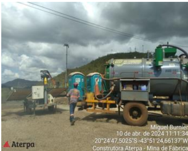
Foto 51. Manutenção dos banheiros químicos disponíveis nas frentes de obra. Vale, abril de 2024.
