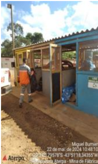
Foto 55: DIR para armazenamento temporário de resíduos no canteiro de Forquilha I e II. Vale, maio de 2024.
