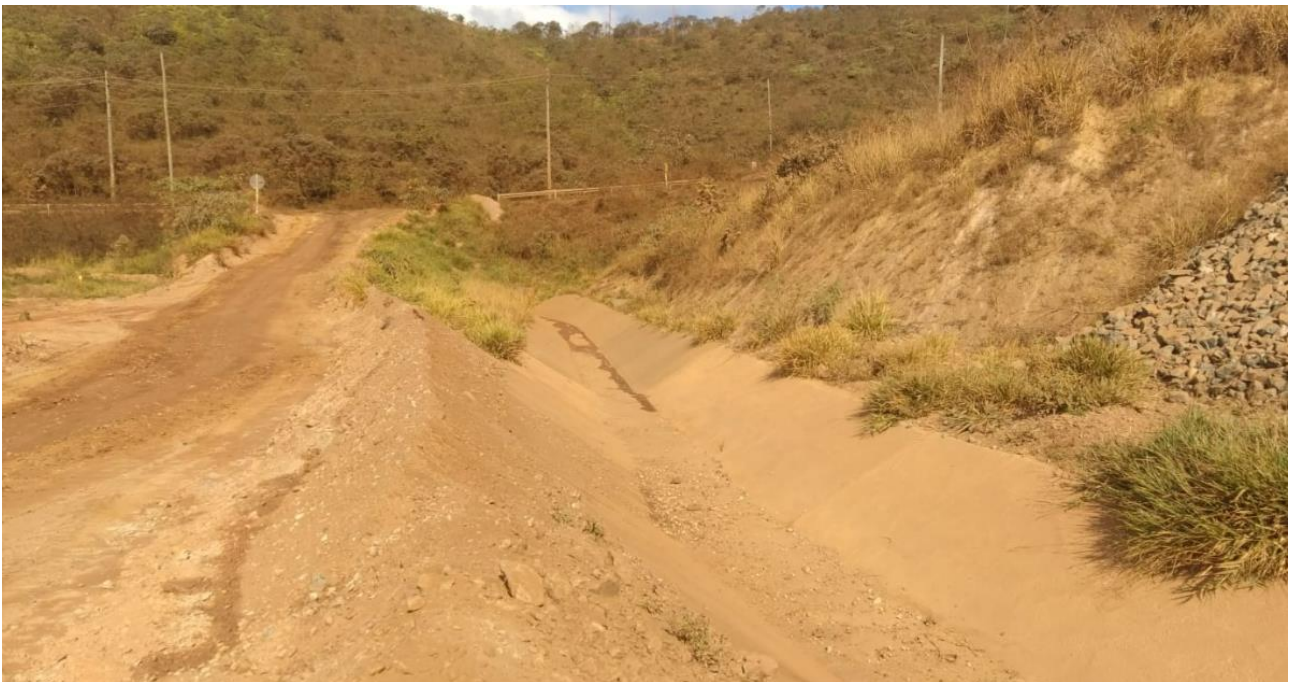
Foto 14. Status da limpeza e desobstrução dos canais de cintura – Forquilha I (julho/24).
