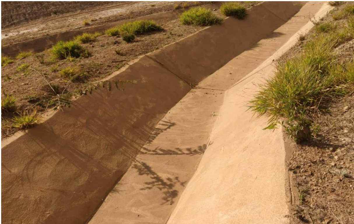
Foto 28. Status da limpeza e desobstrução dos canais de cintura – Forquilha I (Julho/24).
