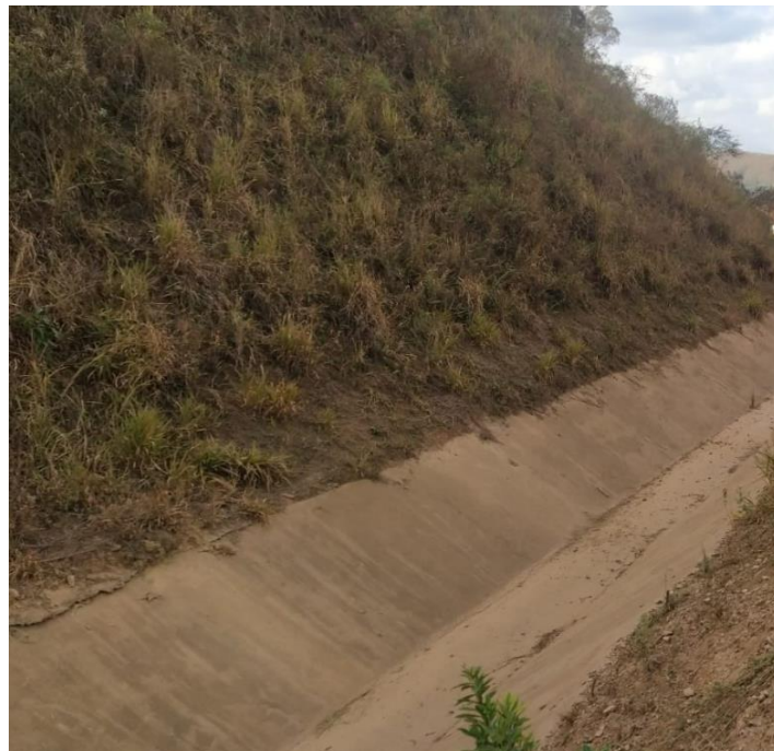
Foto 29. Status da limpeza e desobstrução dos canais de cintura – Forquilha I (julho/24).
