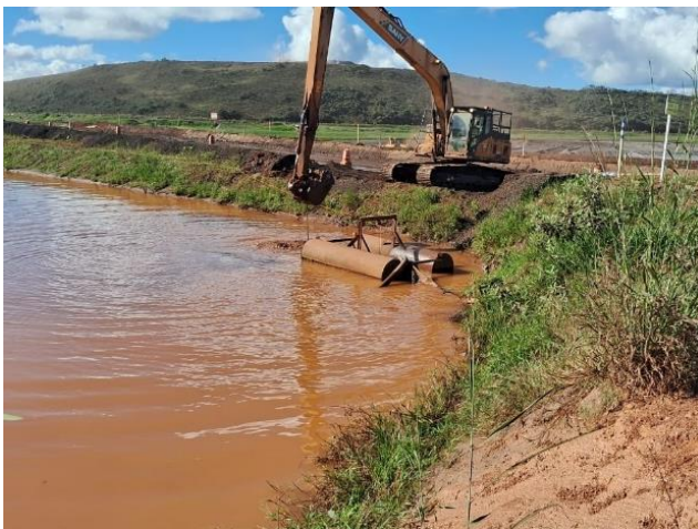
Foto 6: Início da Limpeza do Sump do canal de cintura da Barragem Vargem Grande (Fonte: Vale, 16 de abril de 2024)
