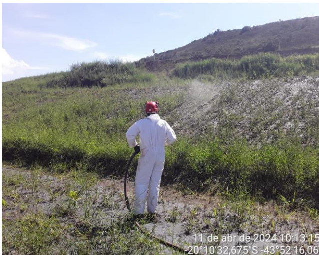
Foto 9: Reaplicação de MVP nos taludes da ombreira esquerda. (Fonte: Vale, fevereiro de 2024)
