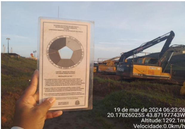
Foto 22: Monitoramento de fumaça preta dos veículos e equipamentos das frentes de serviço. (Fonte: Vale, março de 2024)
