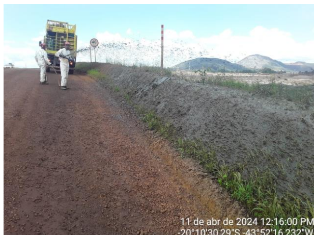
Foto 16: Vista da área do acesso administrativo após revegetação, em processo de germinação. (Fonte: Vale, abril de 2024)
