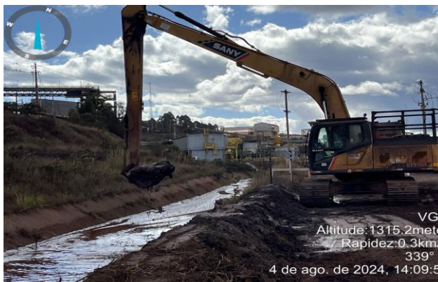
Figura 16 - Execução de limpeza no canal de cintura CC02 (Fonte: Vale, agosto de 2024).
