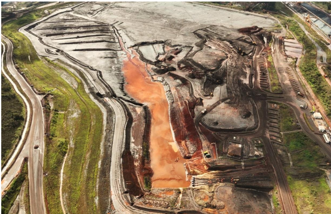
Figura 2 - Vista do Sump 1 de drenagem do reservatório com o sistema de bombeamento operantes (08/01/2025).
