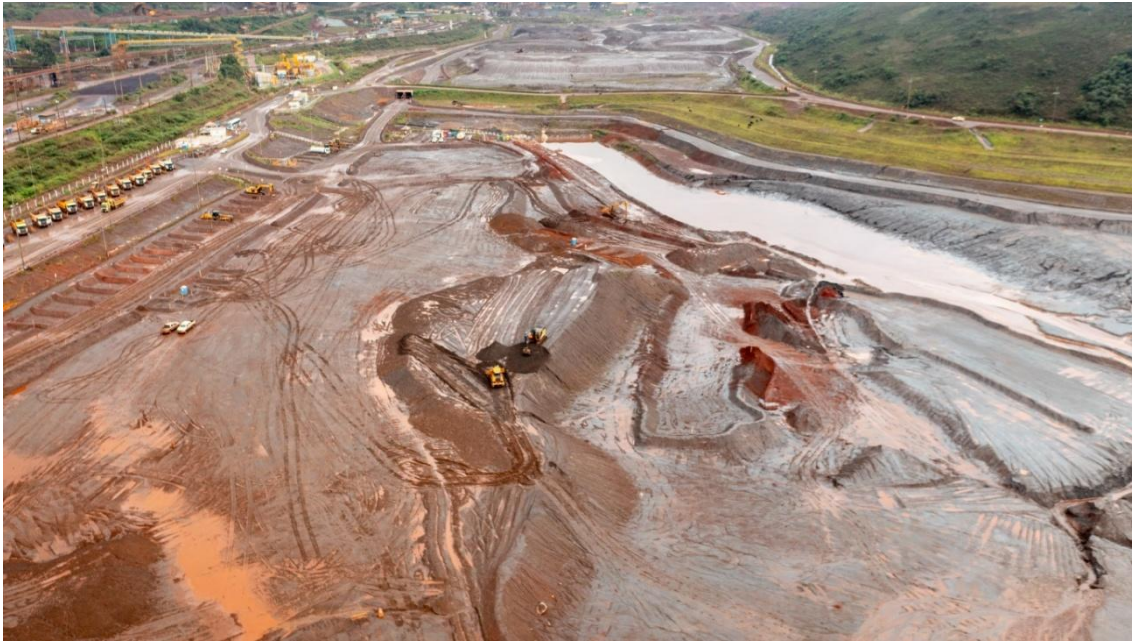
Figura 27 - Vista da Barragem Vargem Grande, após processo de revegetação bem estabelecido da ombreira esquerda da barragem – período chuvoso. (Fonte: Vale, janeiro de 2025).
