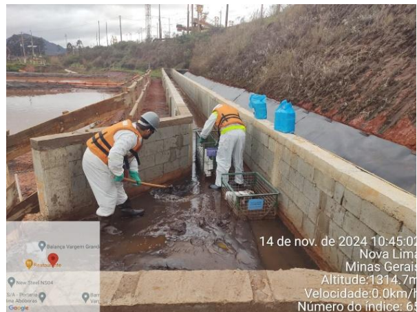
Figura 17 – Limpeza da canaleta de contribuição do SUMP CC02 (Fonte: Vale, novembro de 2024).
