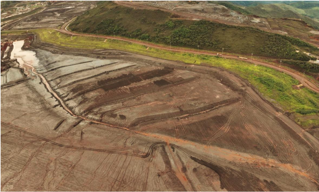
Figura 10 - Vista do reservatório com os canais de drenagem direcionando o efluente para região a montante, junto ao SUMP 01, conforme preconizado no plano de chuvas 24/25 (08/01/2025).
