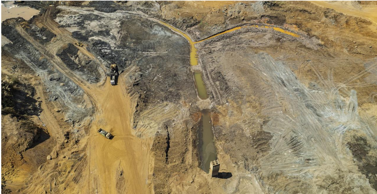
Figura 27. Drenagens internas do reservatório. Fonte: Vale (06/10/2024).
