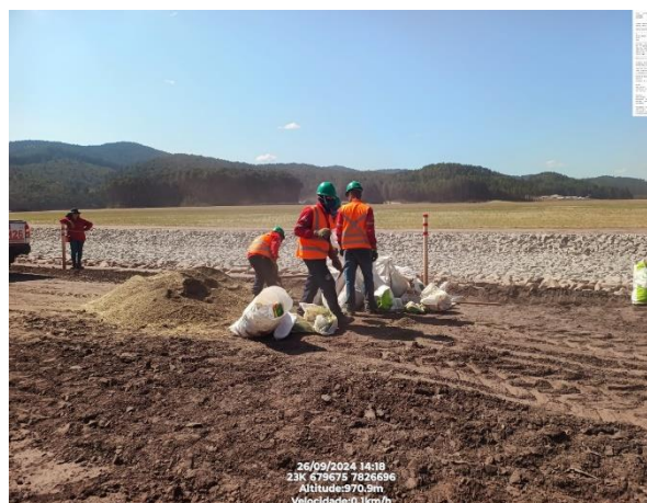
Figura 105 - Preparação do mix de sementes para aplicação na área de plantio do Dique 1A. 26/09/2024. Vale, 2024.
