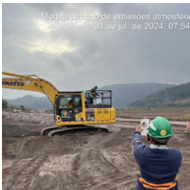
Figura 86 - Controle de emissões atmosféricas proveniente da combustão de motores de equipamentos e veículos movidos a diesel. Dique 1A e 1B. Fonte: Vale, 2024.
