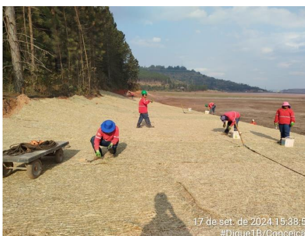
Figura 110 - Biomanta aplicada sobre a área de intervenção no Dique 1B em 17/09/2024 : Fonte: Vale, 2024
