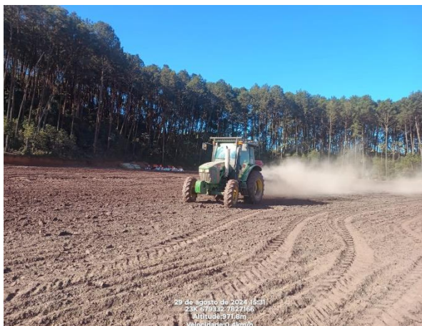
Figura 96 - Execução de práticas de correção do solo em 29/08/2024 nas áreas do Dique 1A. Vale, 2024.
