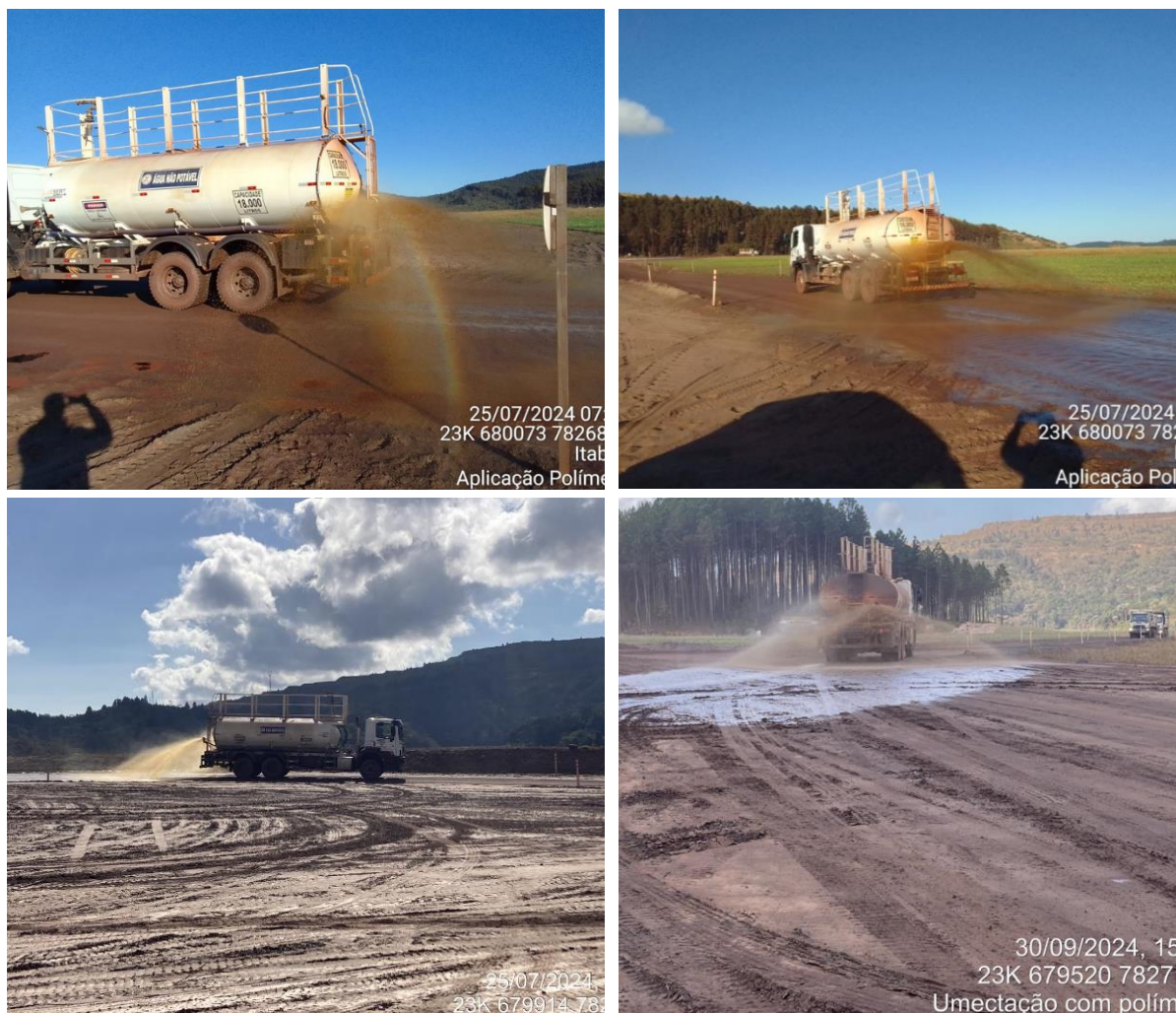
Figura 81, Figura 82, Figura 83 e Figura 84 - Aplicação de polímero supressor de poeira nas principais vias de acesso as obras de descaracterização do Dique 1A e 1B. Fonte: Vale, 2024.
