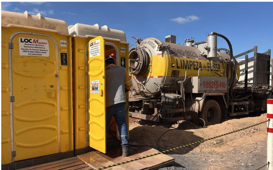
Figura 2 - Evidência de limpeza dos banheiros químicos utilizados nas obras de descaracterização dos Diques 1A e 1B.
