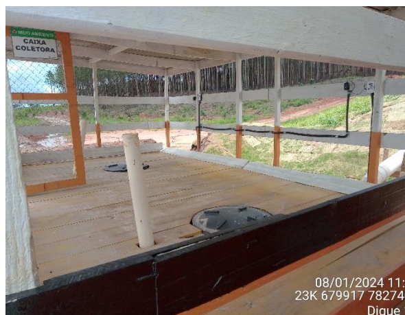
Figura 4 - Estrutura dos tanques de acúmulo de efluentes sanitários instalado no canteiro de obras do Dique 1A.
