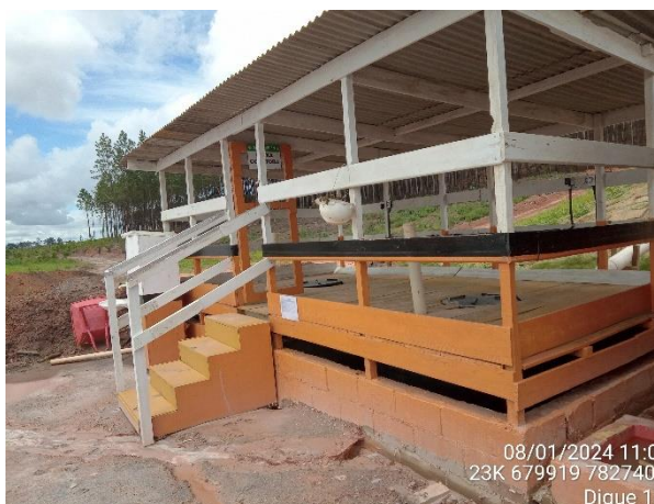
Figura 3 - Estrutura dos tanques de acúmulo de efluentes sanitários instalado no canteiro de obras do Dique 1A.
