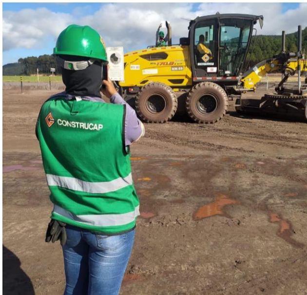
Figura 6 - Controle de emissões atmosféricas proveniente da combustão de motores de equipamentos e veículos movidos a diesel. Diques 1A e 1B. Fonte: Vale, 2024
