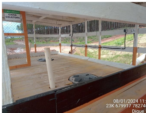
Figura 4 - Estrutura dos tanques de acúmulo de efluentes sanitários instalado no canteiro de obras do Dique 1A.
