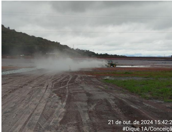
Figura 62 - Execução de práticas de correção do solo em 21/10/2024 nas áreas do Dique 1A. Vale, 2024.
