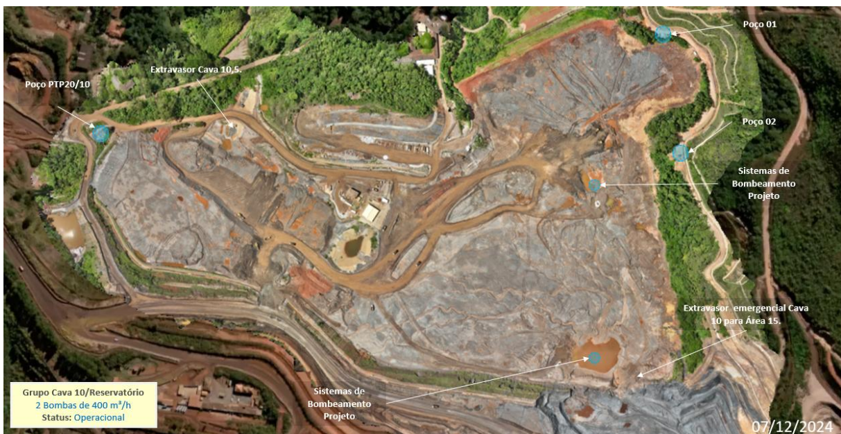
Figura 50 - Operação do sistema de bombeamento no sump do reservatório (dezembro/25).
