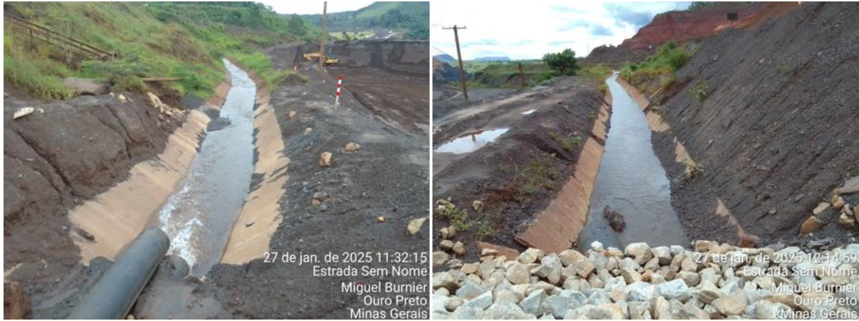
Figura 39 - Estado de conservação e limpeza dos canais de cintura (janeiro/25).
