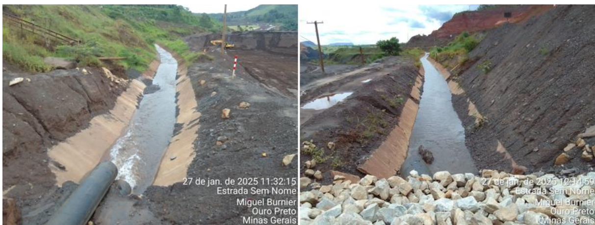
Figura 10 - Estado de conservação e limpeza dos canais de cintura (janeiro/25)
