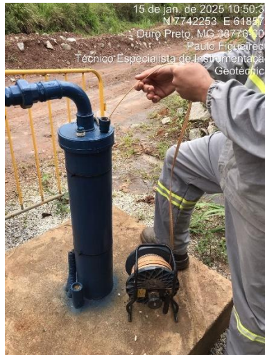
Figura 22 - Monitoramento poço bombeamento PP-GR-01 (janeiro/25)
