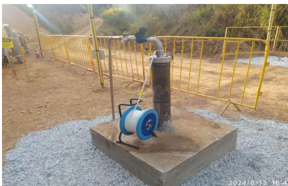
Figura 90 - Poço Tubular Profundo PP-GR-01
