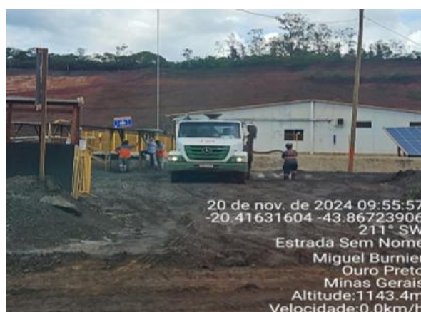
Figura 139 - Recolhimento de efluentes dos tanques localizados no canteiro Avançado, novembro de 2024 (Fonte: Vale, 2024).
