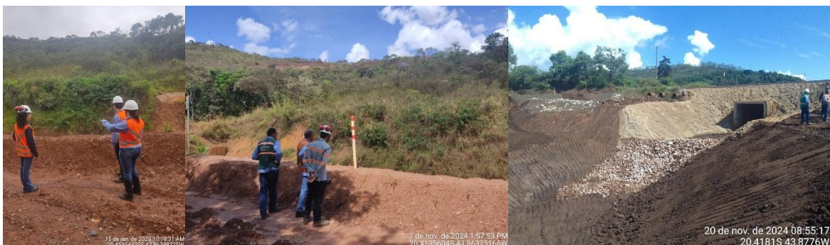
Figura 169 - Inspeções quinzenais para verificação das medidas de controle do período chuvoso 2024/2025. Fonte: Vale, 2025.
