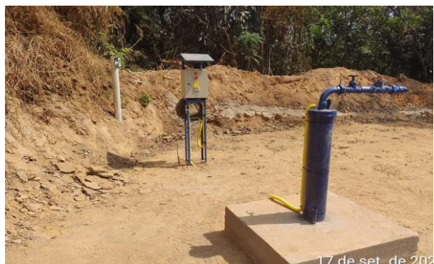
Figura 91 - Poço Tubular Profundo PP-GR-02
