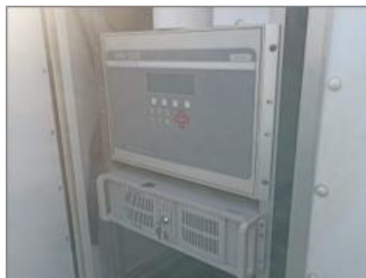
Figura 107 - Estação de Monitoramento de Qualidade do Ar Mota. Fonte: Vale, 2023.
