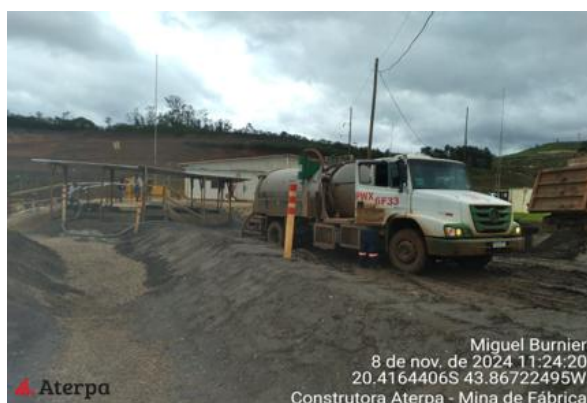
Figura 138 - Recolhimento de efluentes dos tanques localizados no canteiro Avançado, novembro de 2024 (Fonte: Vale, 2024).
