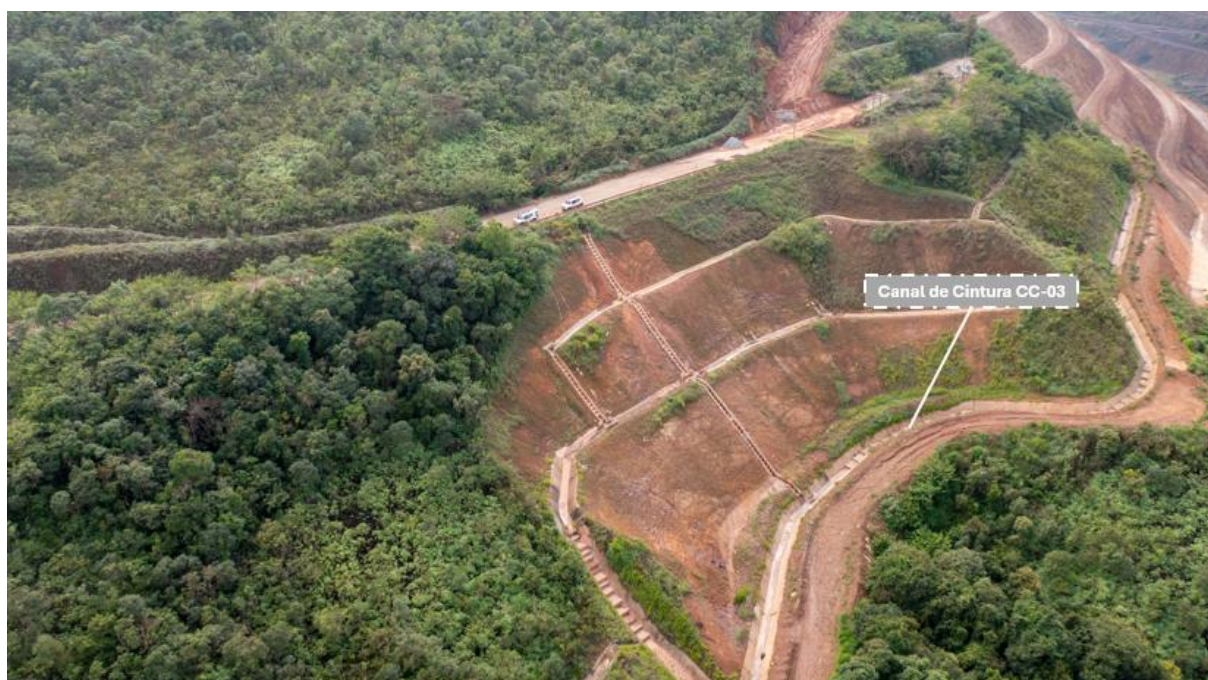
Figura 12 - Estado de conservação e limpeza dos canais de cintura (janeiro/25)
