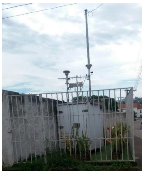
Foto 53: Estação de monitoramento de Qualidade do Ar - Matriz. Fonte: Vale, 2024.
