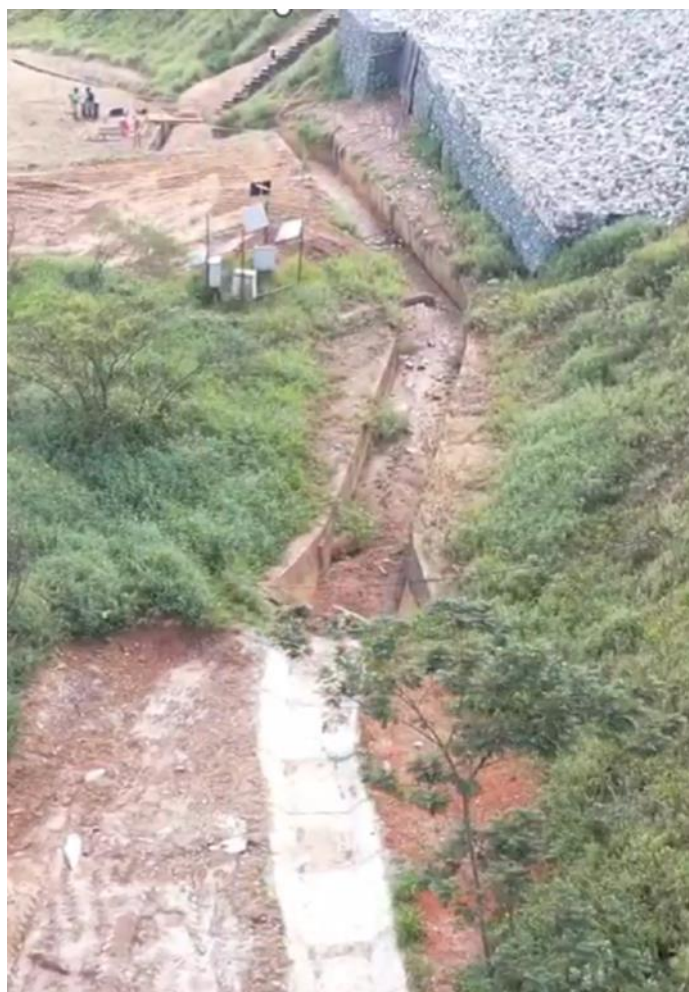
Foto 31: Status da limpeza e desobstrução dos canais de cintura – Forquilha I e II (abril/24)
