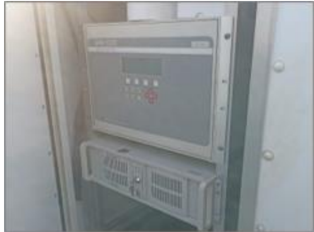
Foto 52. Estação de Monitoramento de Qualidade do Ar de Mota. Fonte: Vale, agosto 2023.
