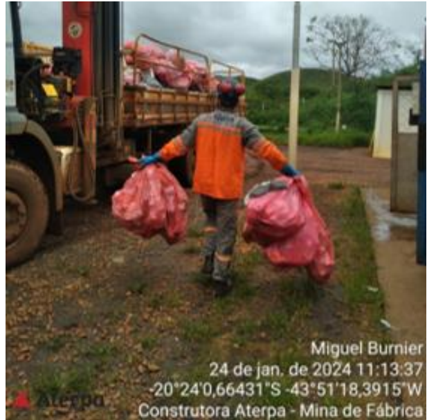
Foto 59. Transporte interno de retirada dos resíduos do DIR Canteiro Forquilhas, para destinação ao CMD. Fonte: Vale, janeiro, 2024.
