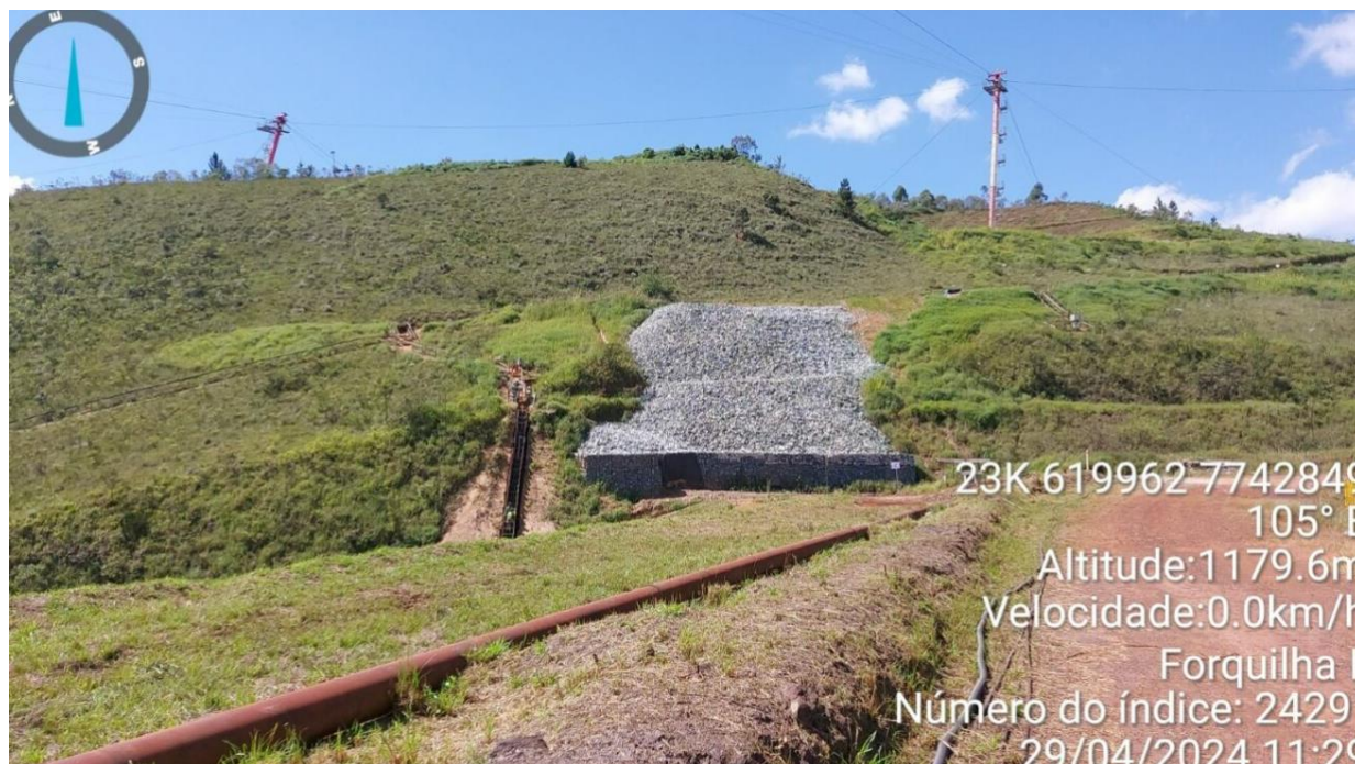
Foto 24. Forquilha II – Correção da anomalia – ombreira direita de Forquilha II (Abril/24).
