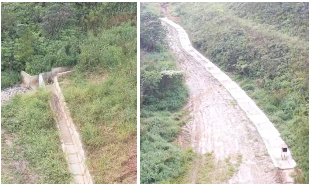
Foto 30: Status da limpeza e desobstrução dos canais de cintura – Forquilha I e II (abril/24)
