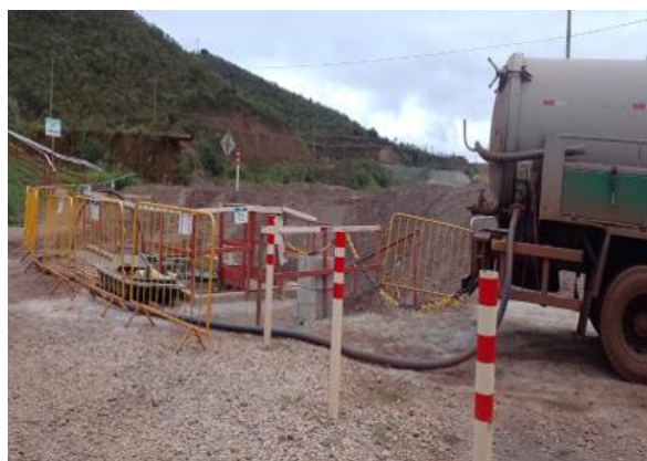
Figura 98 - Recolhimento de efluentes do tanque localizado no Pátio da Oficina, dezembro de 2024 (Fonte: Vale, 2024).
