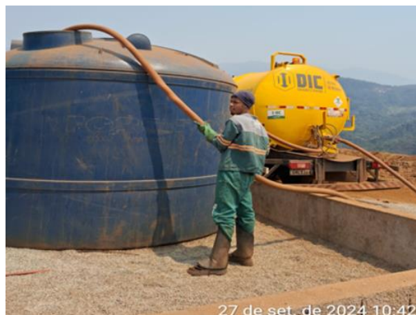
Figura 39 - Limpeza de tanque séptico. Fonte: Vale, (set/2024).
