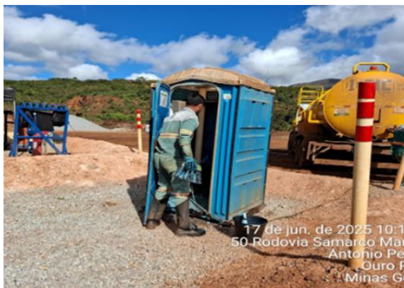
Figura 38 - Limpeza de banheiro químico. Fonte: Vale, 2025.
