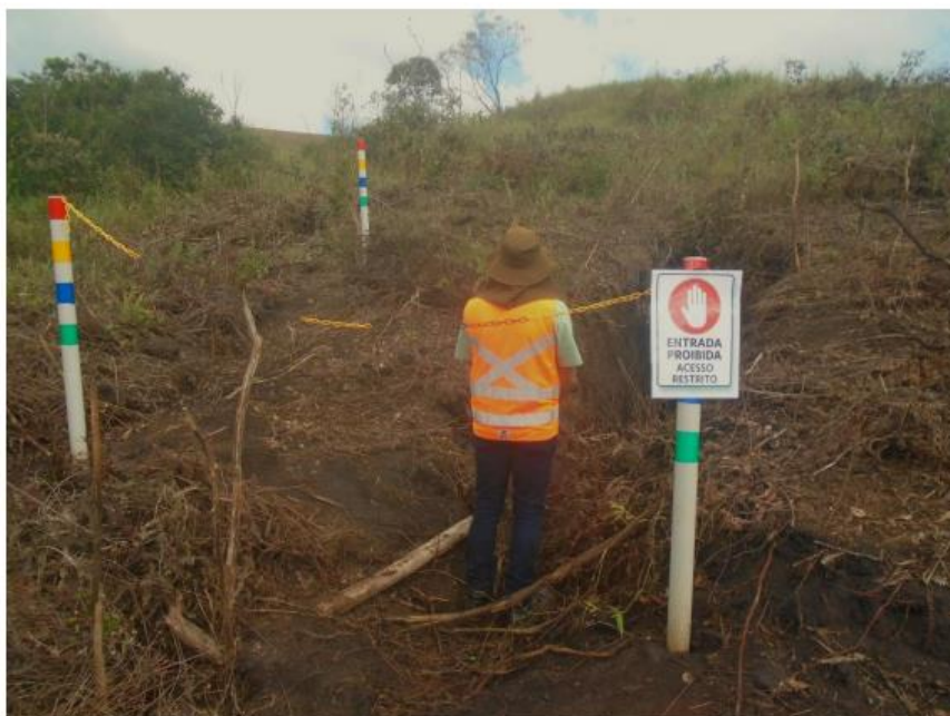
Figura 22 – A área onde se encontra a galeria foi cercada para evitar eventuais danos à estrutura.
