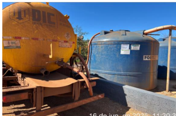
Figura 39 - Sução da caixa de acumulação de efluente sanitário. Fonte: Vale, (2025).
