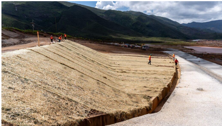
Foto 18 Caneletas e escada de drenagem
