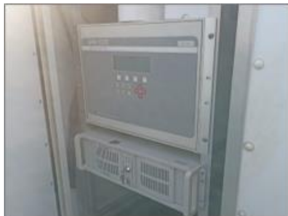
Figura 60 - Estação de Monitoramento de Qualidade do Ar de Mota.
