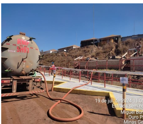
Figura 83 - Recolhimento de efluentes dos tanques de efluentes. Vale, julho de 2024.
