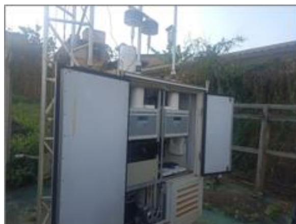
Figura 58 - Estação de Monitoramento de Qualidade do Ar de Pires.
