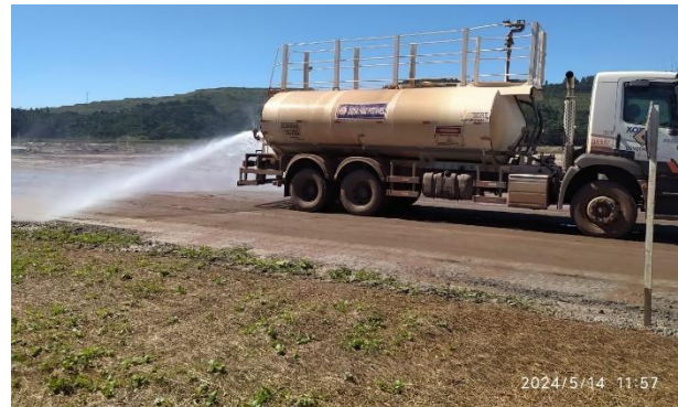
Foto 47. Umectação de vias de acesso as obras de descaracterização do Dique 1A e 1B. Fonte: Vale, 2024.
