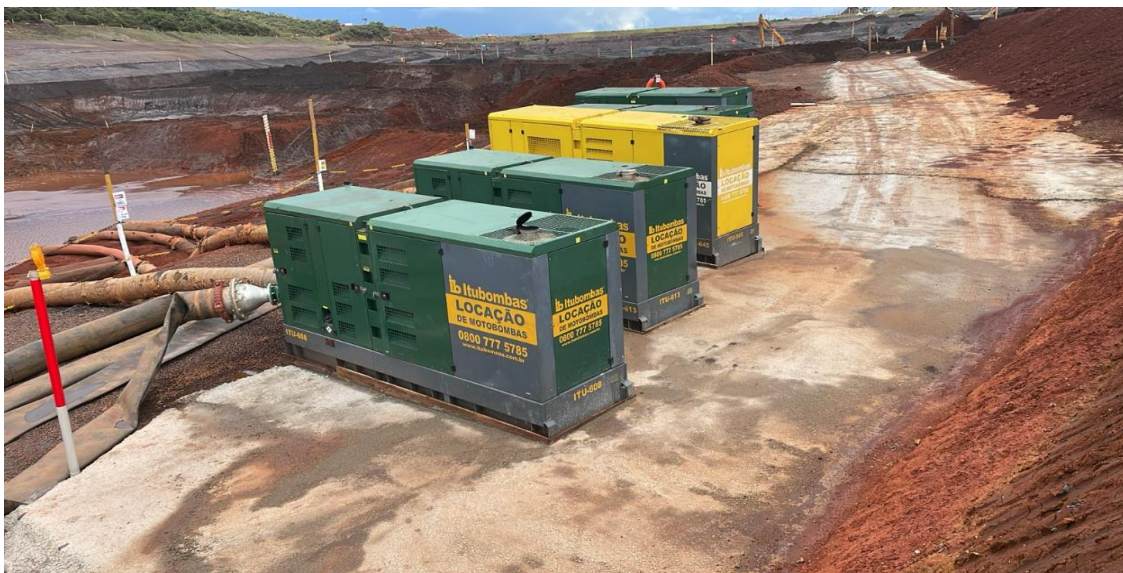
Foto 2: Sistema de bombeamento de contingência durante o período chuvoso 2023/2024 (28/12/2023).
