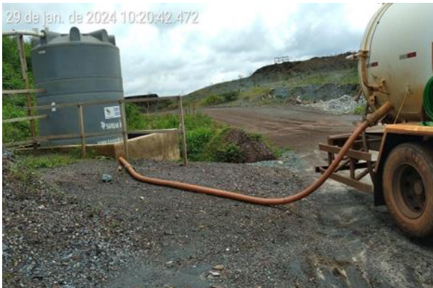
Foto 19: Sucção do tanque séptico no Canteiro. (Fonte: Vale, 2024).
