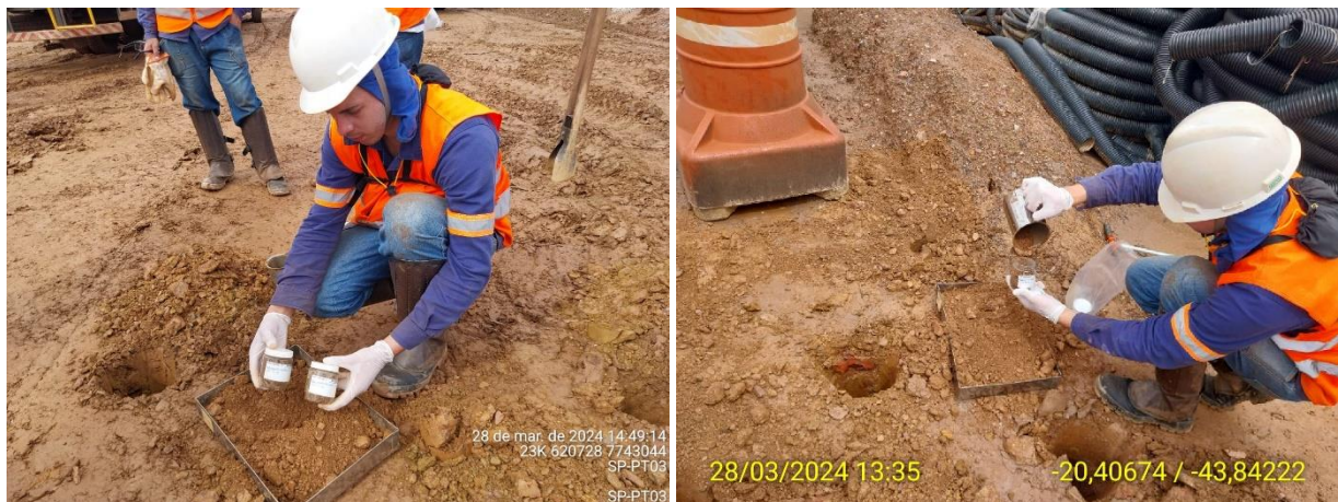
Foto 64 e Foto 65: Amostragem de solo na área do novo canteiro da construtora Barbosa Melo. PT-03, à esquerda, e PT-04 à direita. Fonte: Vale, 2024.
