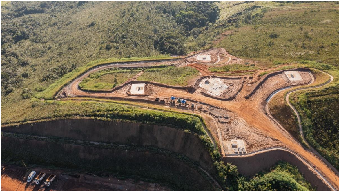
Foto 6: Obras de implantação das fundações do Lift Line fase 2 – Torre T3 – Ombreira Direita (abril/24).
