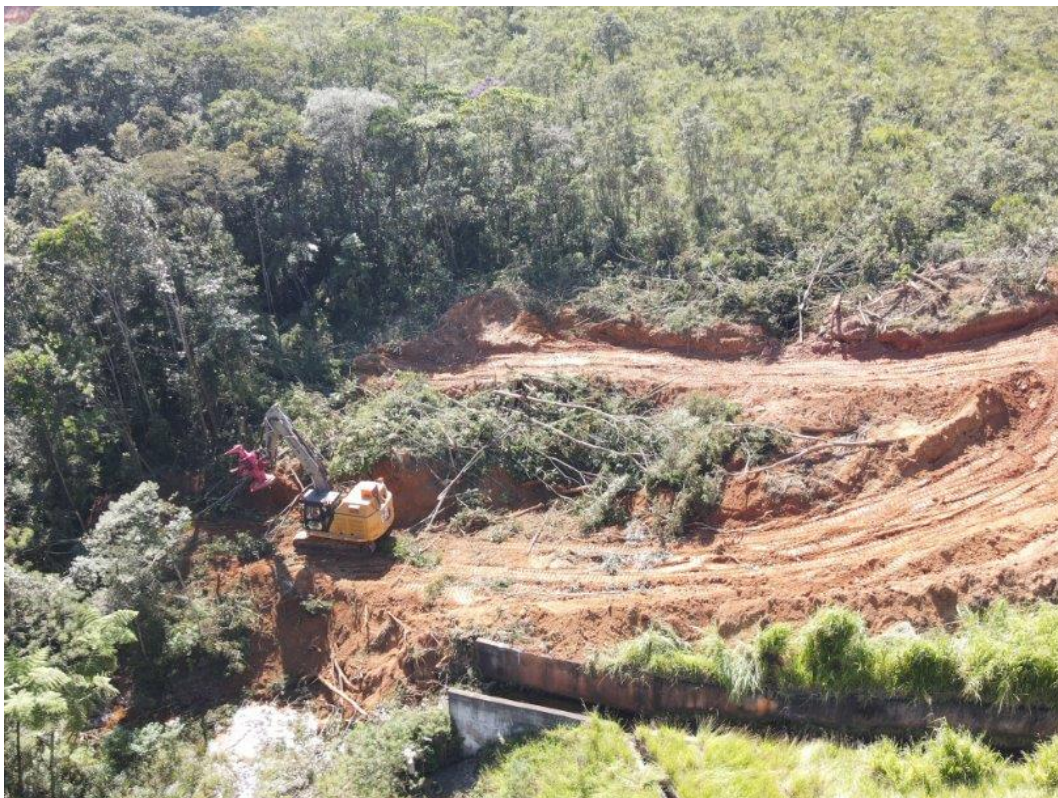
Foto 30: Execução das atividades de supressão de vegetação área da jusante de Forquilha III (fonte: Vale, 2024).
