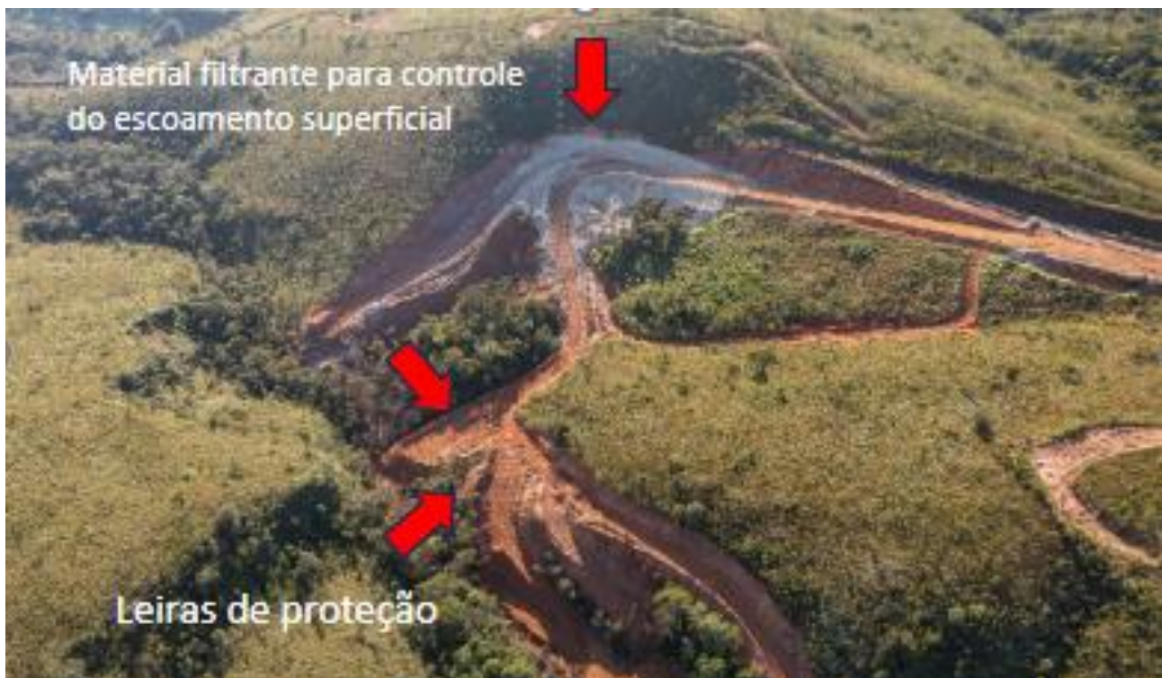
Figura 43: Ações de controle de processos erosivos na ZAS de Forquilha III. Fonte: Vale, 2024.
