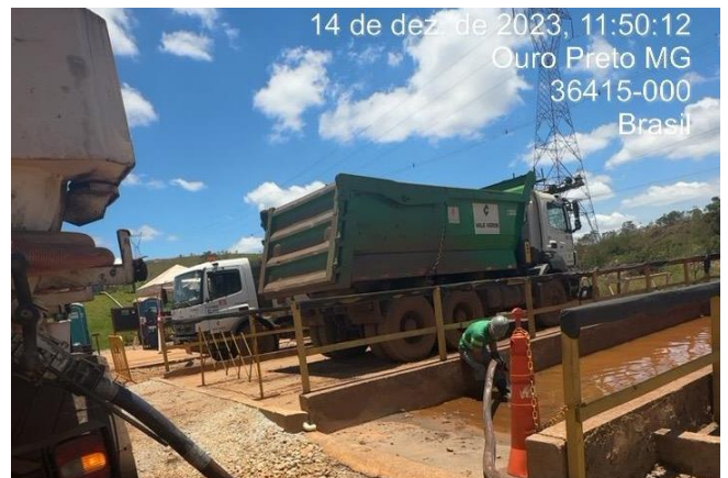
Foto 45: Sucção de efluente da caixa SAO. (Fonte: Vale, 2023).
