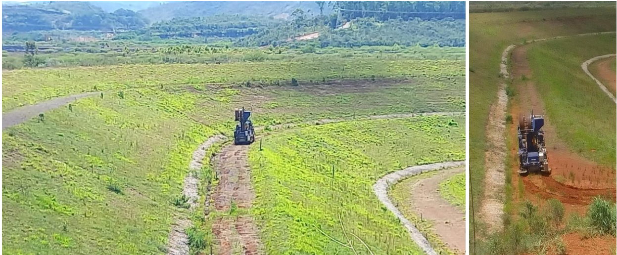
Foto 7: Deep Drive executando campanha de SCTPU e instrumentação Barragem Forquilhas III (4º alteamento).
