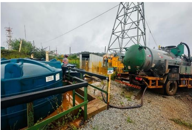
Foto 44: Última sucção do tanque séptico realizado em janeiro de 2024. (Fonte: Vale, 2024).
