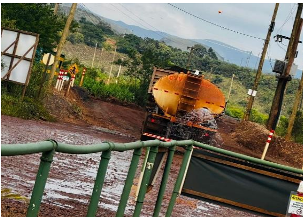
Foto 33: Aspersão de acessos no canteiro da Vale Verde que atende as obras preparatórias de Forquilha III. Fonte: Vale, 2023.
