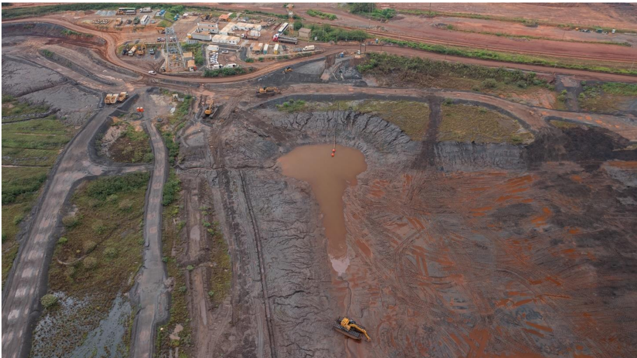
Foto 4: Sistema de bombeamento implantado no Sump 1 de Forquilha III (imagem Dezembro/23).
