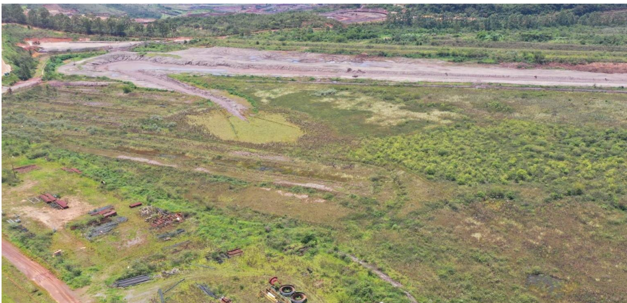
Foto 2. Forquilha II – Canal do teste piloto e canal do plano de chuva – em operação (janeiro/23).
