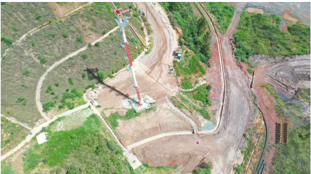
Foto 6. Conclusão da obra de implantação do complemento do Canal de Cintura de Forquilha II (Janeiro, 2024).
