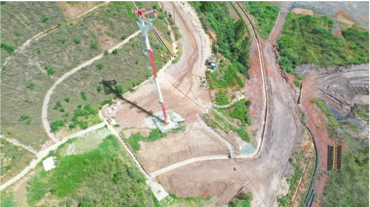
Foto 18: Conclusão da obra de implantação do complemento do Canal de Cintura de Forquilha II (Janeiro 2024)
