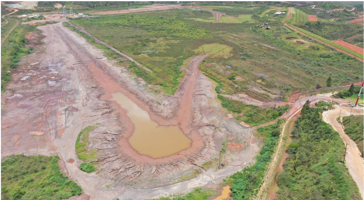
Foto 8. Forquilha II – Canal do teste piloto e canal do plano de chuva – em operação (janeiro/23)..
