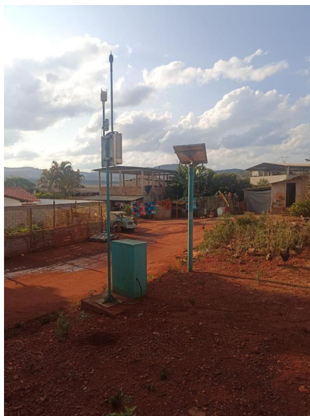
Foto 42. Estação de Monitoramento de Ruído na localidade de Mota. Vale, 2023.
