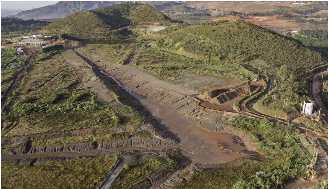
Foto 1. Forquilha I – Canal do teste piloto e canal do plano de chuva (Abril/24).
