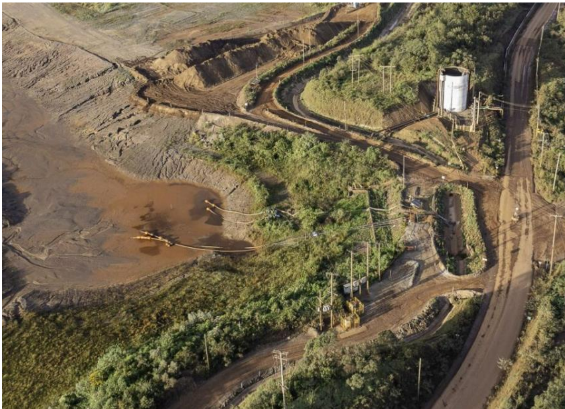
Foto 2. Forquilha I – Sump e sistema de bombeamento (Abril/24).
