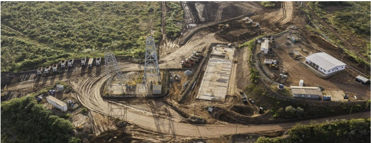
Foto 23. Forquilha I – Mobilização e construção de canteiro de obras à margem montante de Forquilha I e II (Abril/24).
