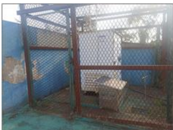
Foto 51. Estação de Monitoramento de Qualidade do Ar de Mota. Fonte: Vale, agosto 2023.
