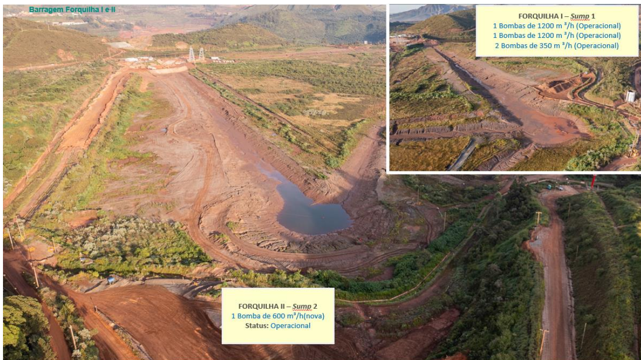
Figura 18: Sistemas de bombeamento de Forquilhas I e II – Implantação concluída (Abril/24).
