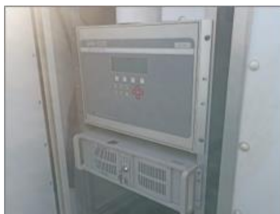
Foto 52. Estação de Monitoramento de Qualidade do Ar de Mota. Fonte: Vale, agosto 2023.
