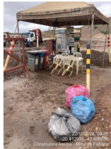
Figura 114 – Recolhimento de resíduos na frente de serviço para estoque provisório no DIR. (Fonte: Vale, 2024)
