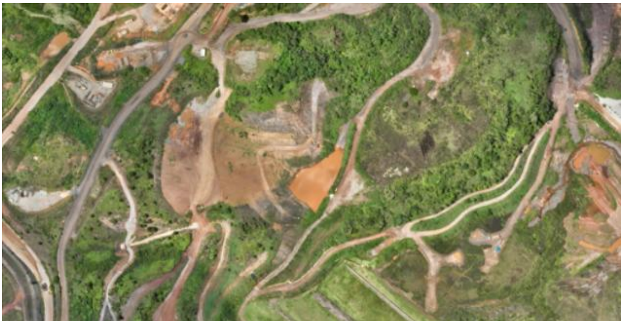
Figura 17 - Forquilha I - Correção de anomalia ombreira esquerda de Forquilha I (Janeiro/25).
