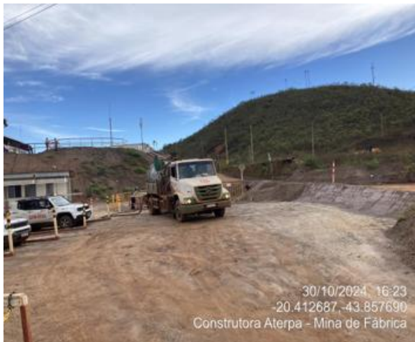
Figura 107 - Recolhimento de efluentes do tanque localizado no Pátio da Oficina (Fonte: Vale, 2024).
