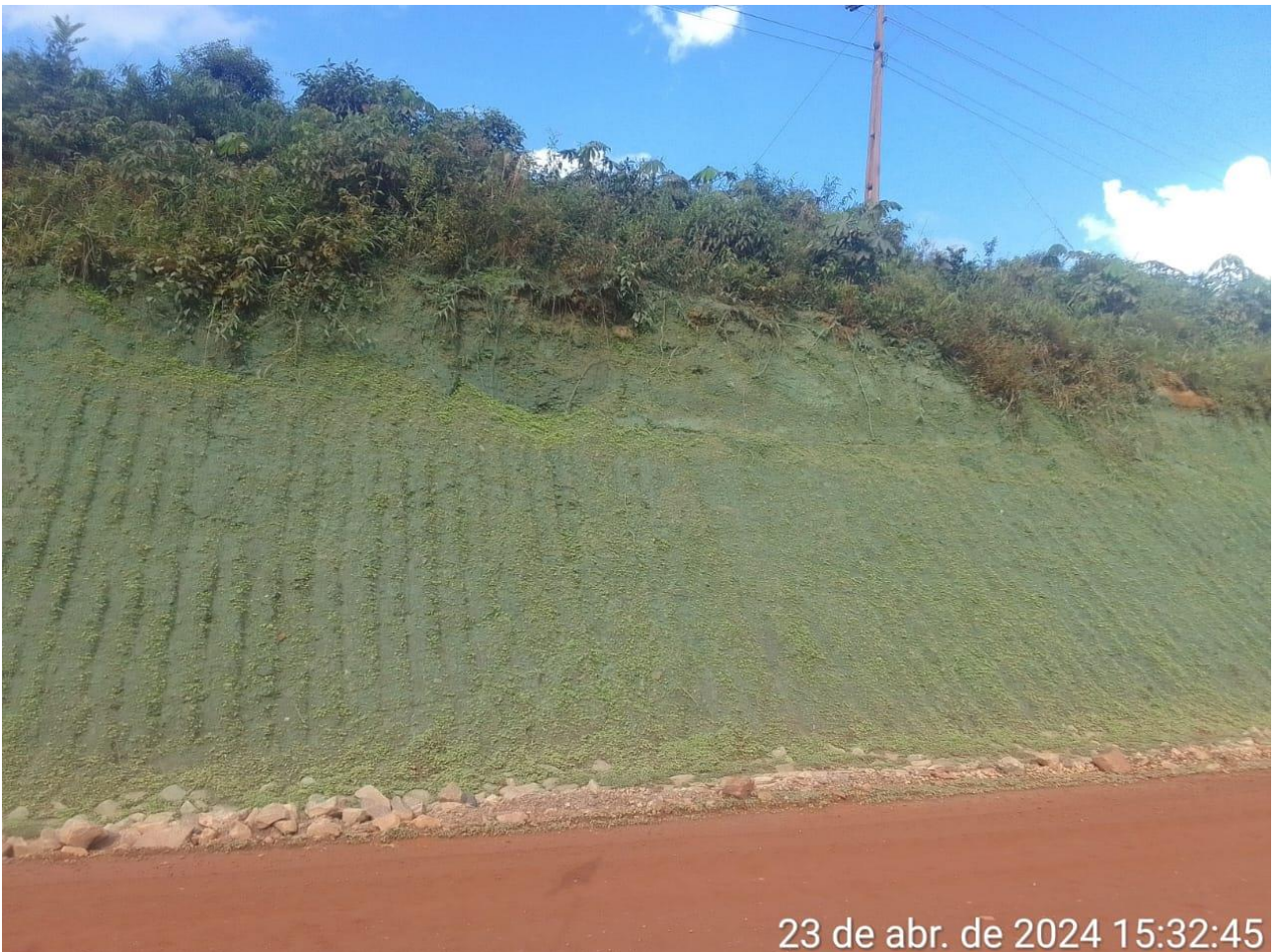
Foto 32: Foto demonstrando a germinação da vegetação no talude após aplicação de hidrossemeadura. Fonte: Vale, abril de 2024.
