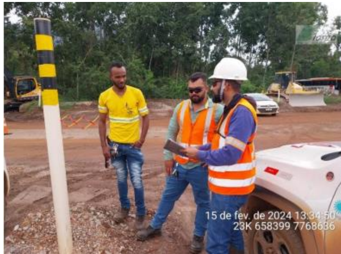
Foto 19. Equipe de fauna, acompanhamento de supressão da vegetação na barragem Campo Grande. Fonte: Bioma (02/2024).
