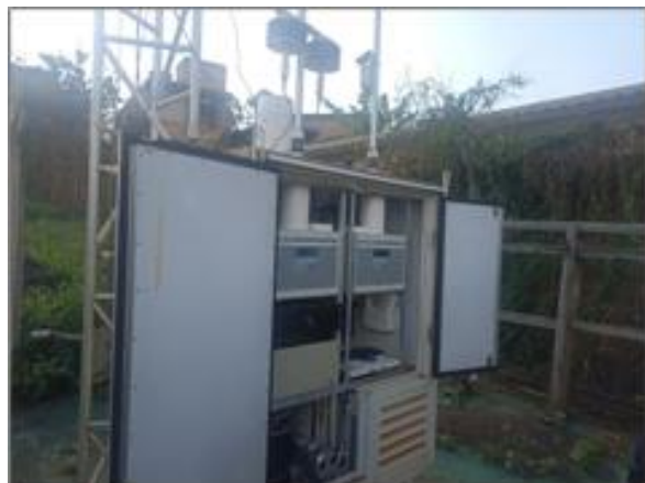
Foto 17. Estação de Monitoramento de Qualidade do Ar de Pires.
