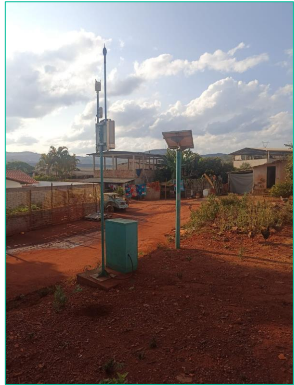
Foto 6. Estação de Monitoramento de Ruído de Ruído. Vale, 2023.
