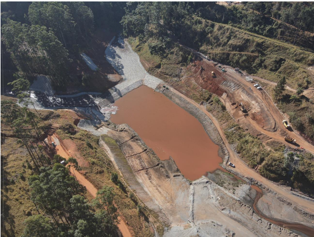
Foto 1, Foto 2 e Foto 3. Sump - etapa I do projeto de rebaixamento do N.A do dique Minervino.
