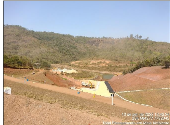
Figura 19. No sentido sul, observa-se estruturas relacionadas às obras e estabilização da barragem.
