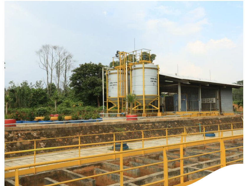
Lamella Gravity Settler (LGS) di PT Vale Indonesia Tbk dioperasikan sejak 2014. Teknologi ini biasanya digunakan untuk pengolahan air minum, PT Vale merupakan tambang pertama yang memanfaatkan teknologi ini untuk pengolahan limbahnya.
