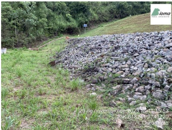
Foto 38: Dreno de Fundo
