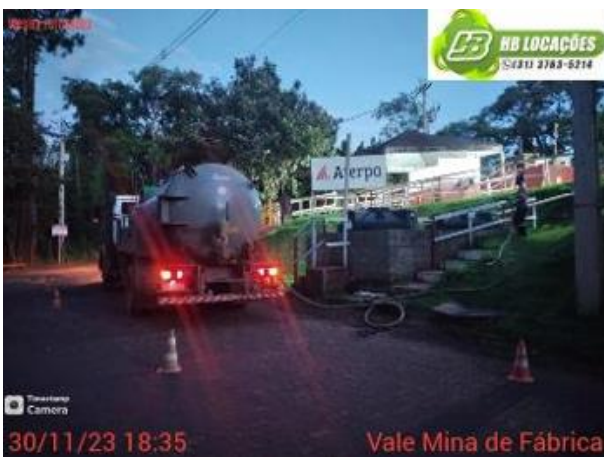
Foto 28. Vista do tanque séptico instalado no canteiro de obras. Fonte: Vale, 2023.
