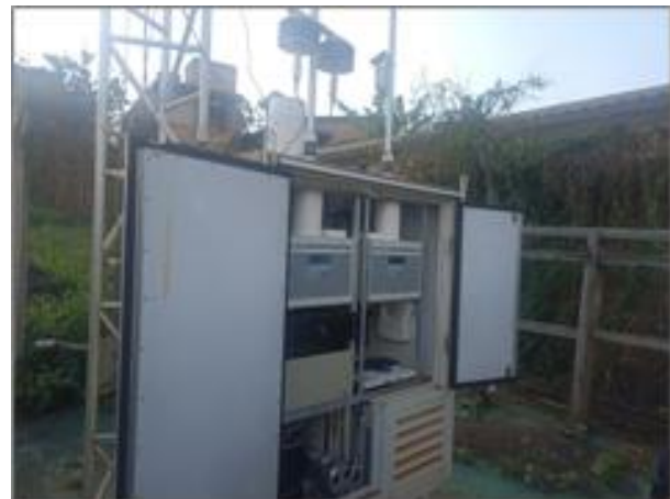
Foto 24. Estação de Monitoramento de Qualidade do Ar de Pires.
