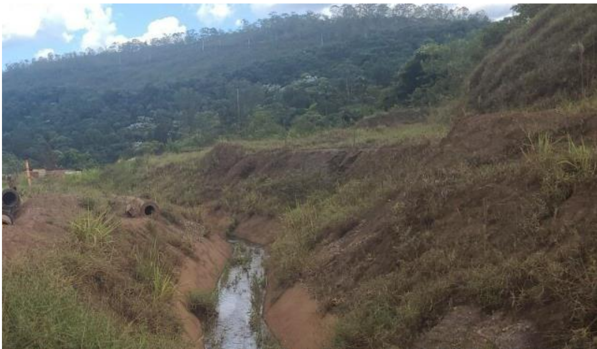
Foto 16: Canal CC01 em operação normal – Grupo (janeiro/24).
