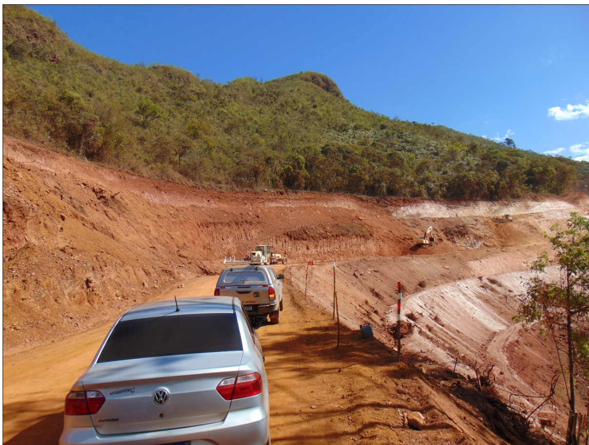
Figura 43. Em trecho da AEL, obras na MGC-262 causam interrupções no tráfego viário.
