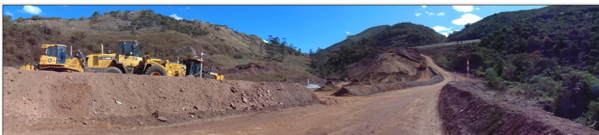
Figura 38. Vista panorâmica da ADA e AEL, no sentido Sul-Norte, voltada para a continuidade da rodovia em direção à Caeté. A rodovia passa por obras, sob a responsabilidade do DER/MG, conforme a imagem.
