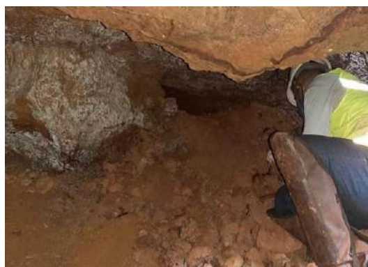
Foto 59 - Em outra entrada da Galeria 25, adjacente a lavra gigantesca voçorocada, há conduto escavado recente. Notar as marcas de escavação na parede composta de sedimentos.
