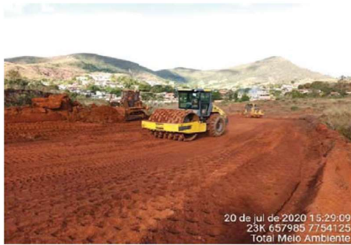
Foto 04 Obras de implantação do sistema extravasor da barragem Doutor Autor: Total meio Ambiente, 2020
