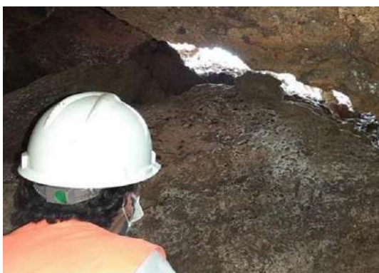
Foto 58 - Trecho de teto abatido da Galeria 25, alterando a morfologia original da galeria.
