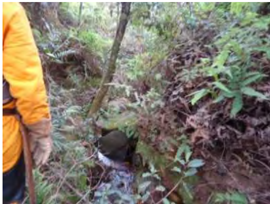
Figura 182: Blocos rolados dentro da drenagem ativa.
