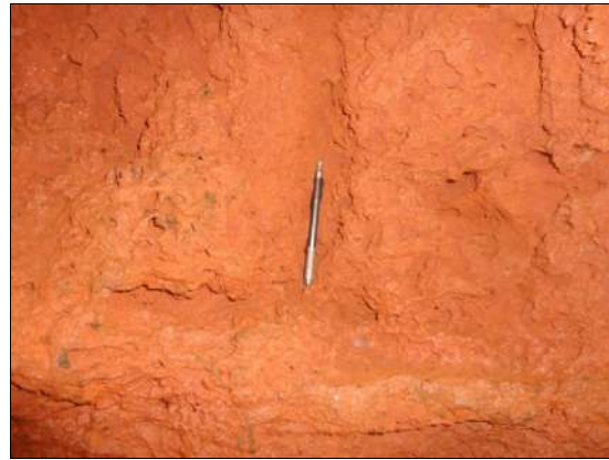
Foto 6.64 - "Canelura", promovida na parede devido a circulação de água proveniente de intenso gotejamento.
