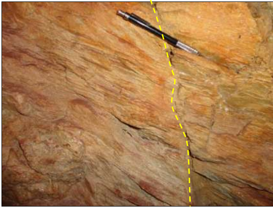
Foto 6.108 - Fratura sem alargamento, observada na parede da cavidade.
