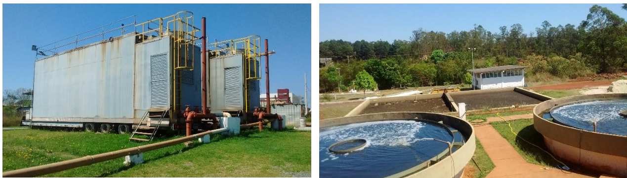
Figura 51 – Vista da Estação de Tratamento de Esgotos do bairro Jardim Canadá, operada pela COPASA.
