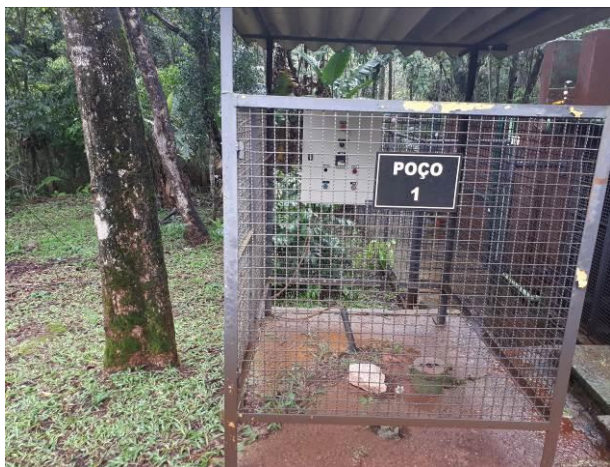
Figura 46 - Poço 01 do Condomínio Jardim Monte Verde.
