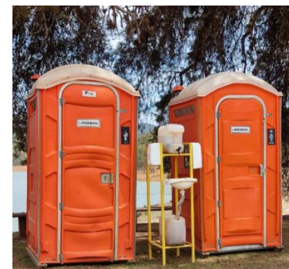
Banheiros químicos utilizados nos canteiros de obra
