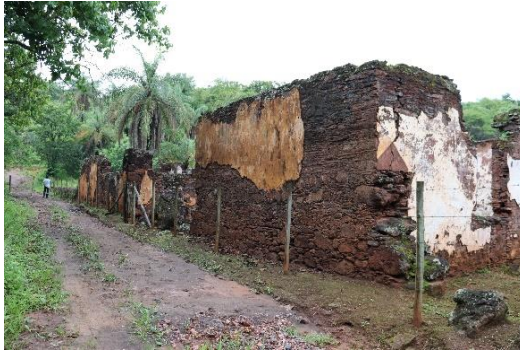
Figura 6-229 - Edificações da Vila de Gongo Soco em ruínas.
