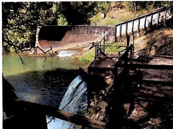
(i) Saída da tubulação de fundo das tulipas e final do rápido.
