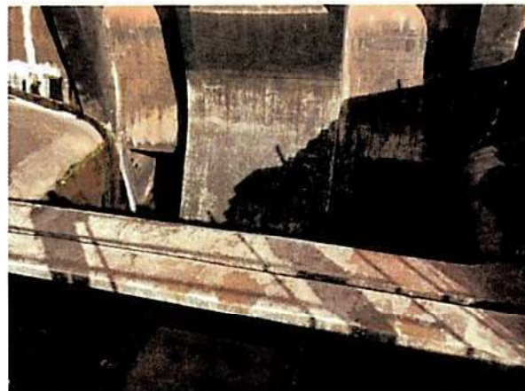
(e) Saída das adufas e do sifão, ao centro.
