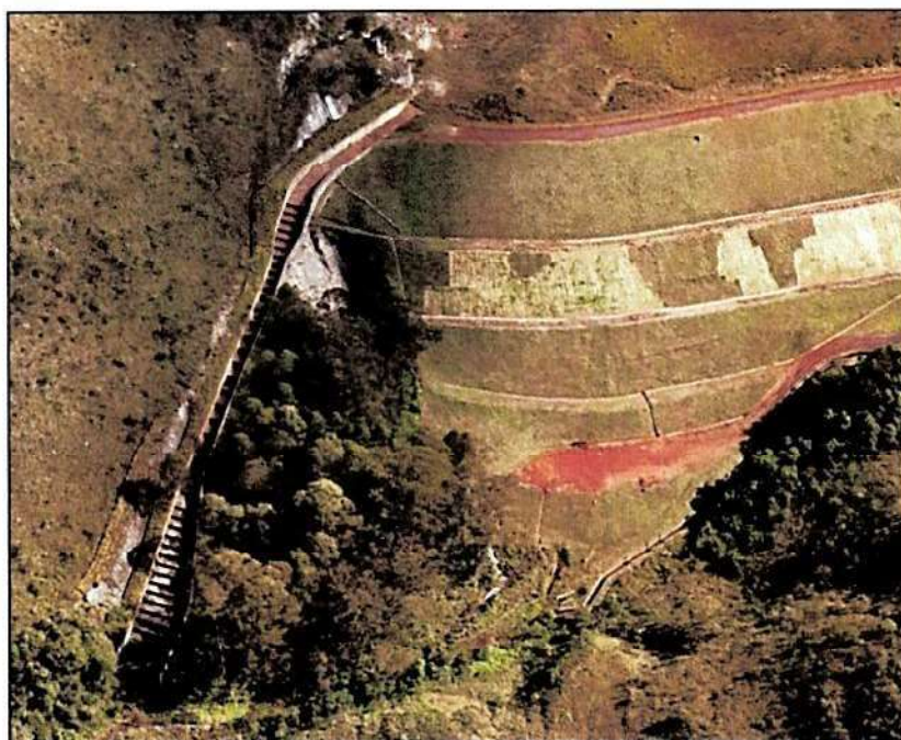
Figura 3.4 – Sistema extravasor da Barragem Peneirinha (Fonte: Doc. [6]).
