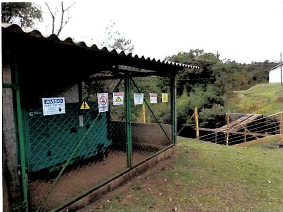
Figura 2 – Gerador a diesel disponível na Barragem Miguelão
