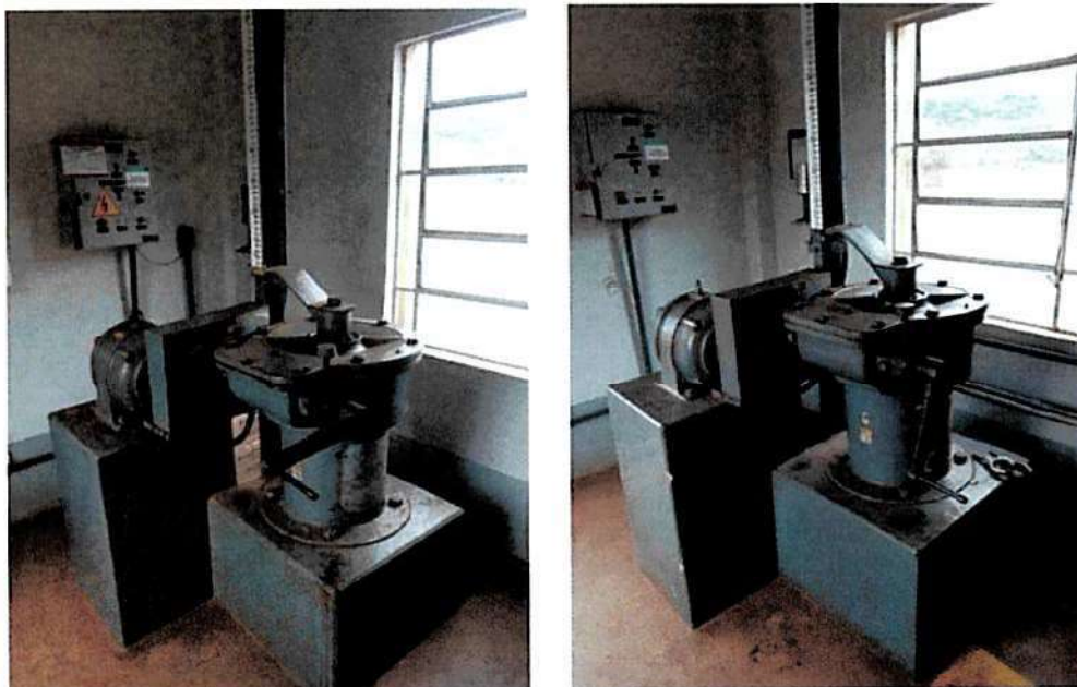
Figura 1 - Comporta 5 e 6 - Imagem de acionamento eletromecânico e manipulô de acionamento manual
