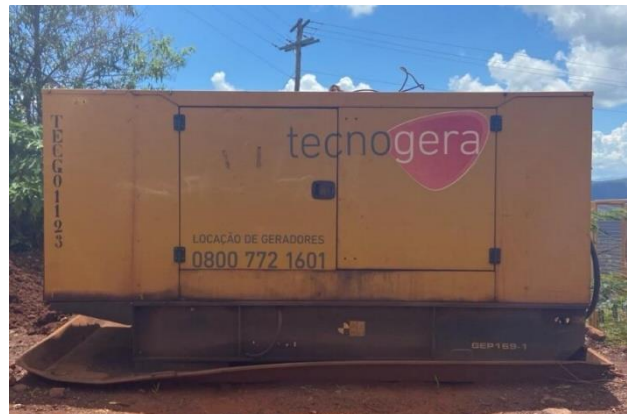
Foto 23. Gerador a diesel para funcionamento do poço de rebaixamento e apanhador de água. (Fonte: Vale, dezembro de 2023).
