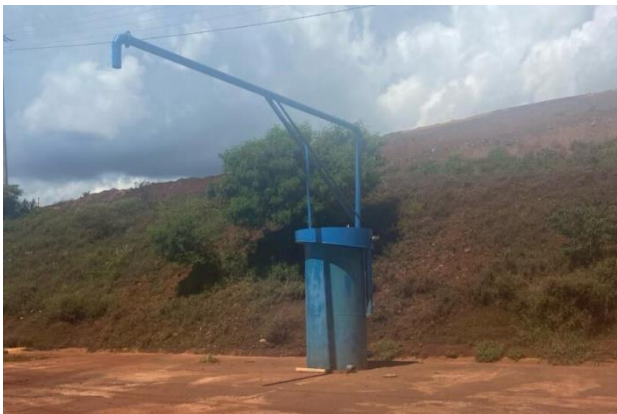
Foto 22. Apanhador de água implantado no Poço de Rebaixamento 03 (Fonte: Vale, janeiro de 2024).
