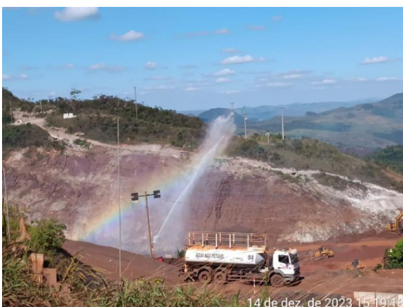
Foto 15. Canhão aspersor instalado na berma superior ao acesso. (Fonte: Vale, dezembro de 2023).
