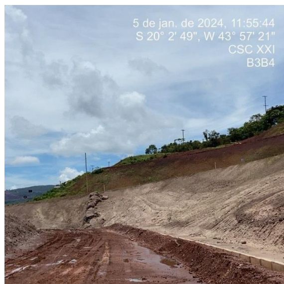
Foto 5. MVP aplicado na ombreira direita. (Fonte: Vale, 05 de janeiro de 2024).
