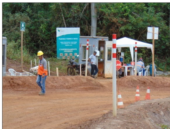
Figura 31. Trabalhadores realizando o retaludamento da estrada que liga Novo Bento Rodrigues ao Bento Rodrigues original (P7).
