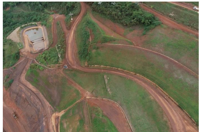
Foto 4. Canal de cintura e drenagens - Obras de descaracterização da barragem B3/B4. (Fonte: Vale, abril de 2024).
