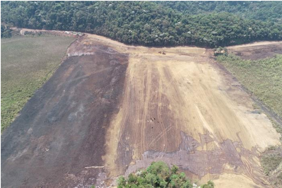
Figura 11: Dique Auxiliar B5 descaracterizado (15/09/22).
